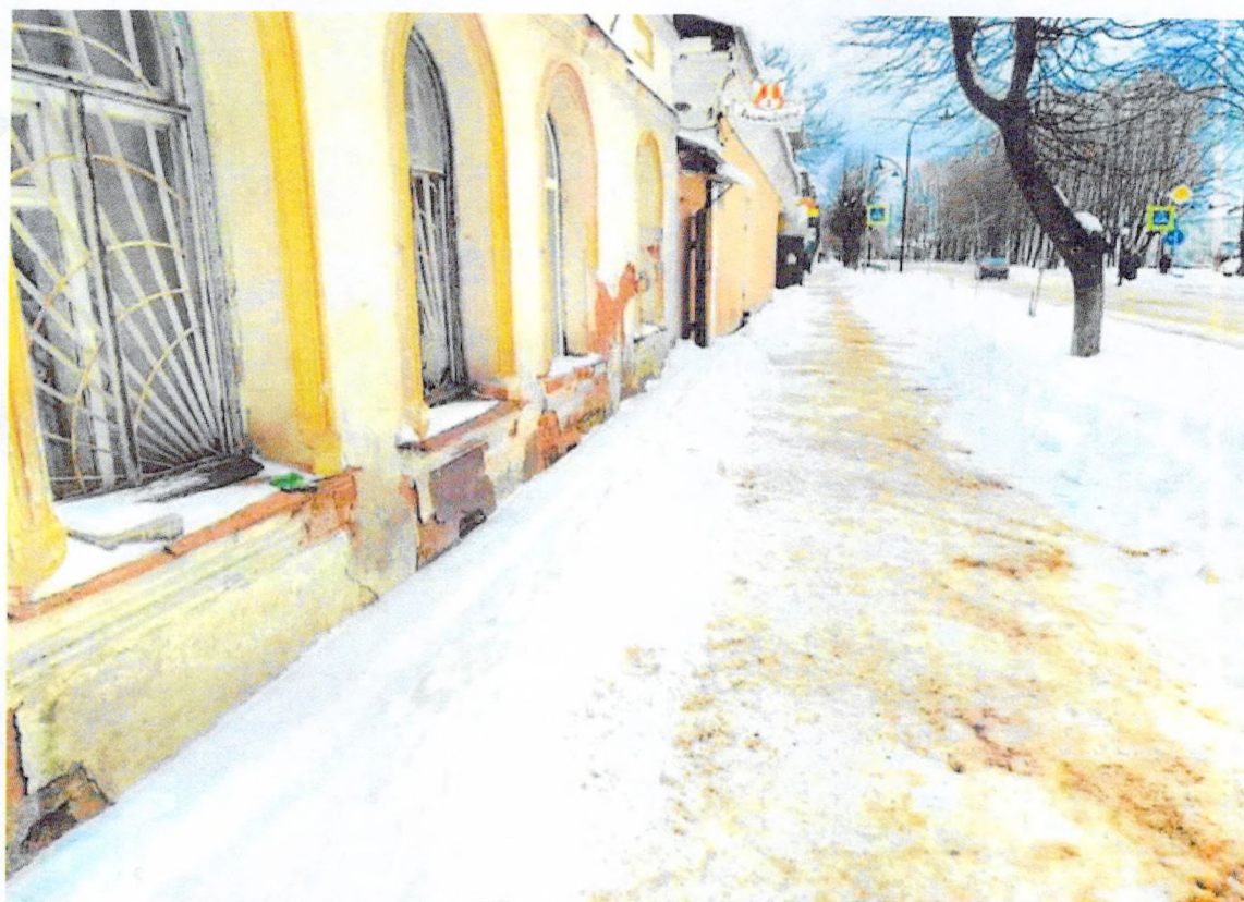
Фото 14. «Бывший дом Марфина, впоследствии богадельня, сер. XIX в.», отслоение штукатурного слоя от кирпичных стен здания.
