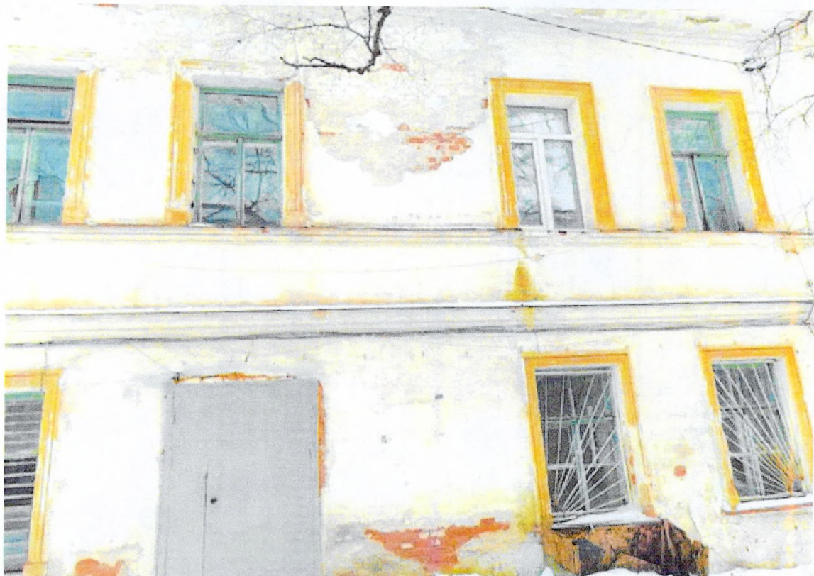
Фото 6. «Бывший дом Марфина, впоследствии богадельня, сер. XIX в.», отслоение штукатурного слоя от кирпичных стен.
