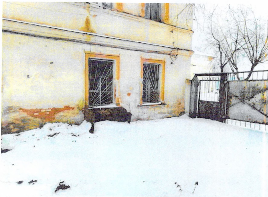
Фото 9. «Бывший дом Марфина, впоследствии богадельня, сер. XIX в.», отслоение штукатурного слоя от кирпичных стен здания.
