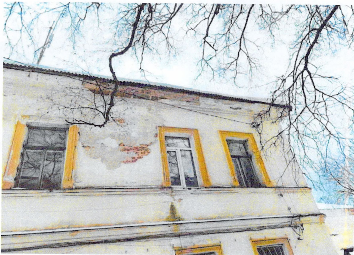
Фото 11. «Бывший дом Марфина, впоследствии богадельня, сер. XIX в.», отслоение штукатурного слоя от кирпичных стен здания.
