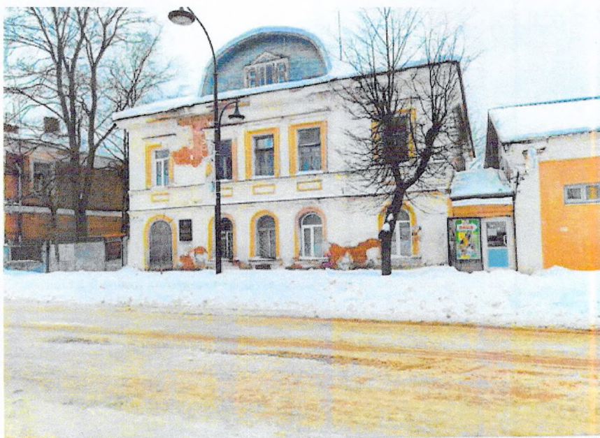
Фото 2. «Бывший дом Марфина, впоследствии богадельня, сер. XIX в.», отслоение штукатурного слоя от кирпичных стен юго-восточного фасада.
