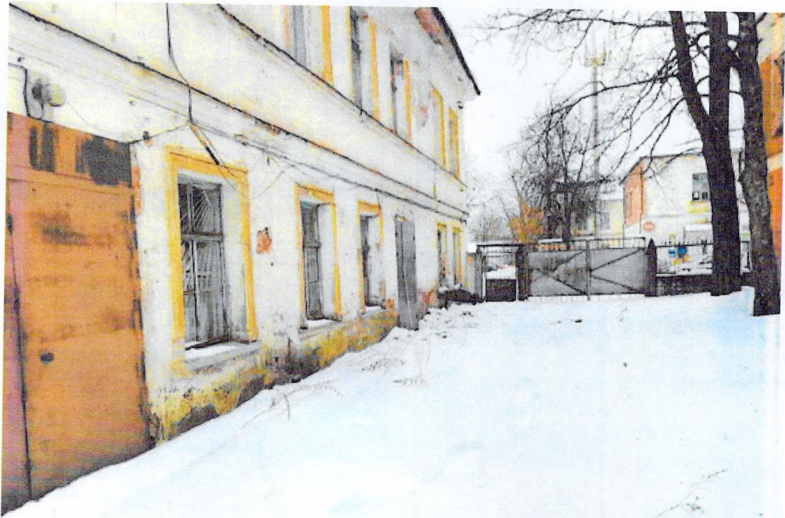
Фото 5. «Бывший дом Марфина, впоследствии богадельня, сер. XIX в.», отслоение штукатурного слоя от кирпичных стен юго-восточного фасада.
