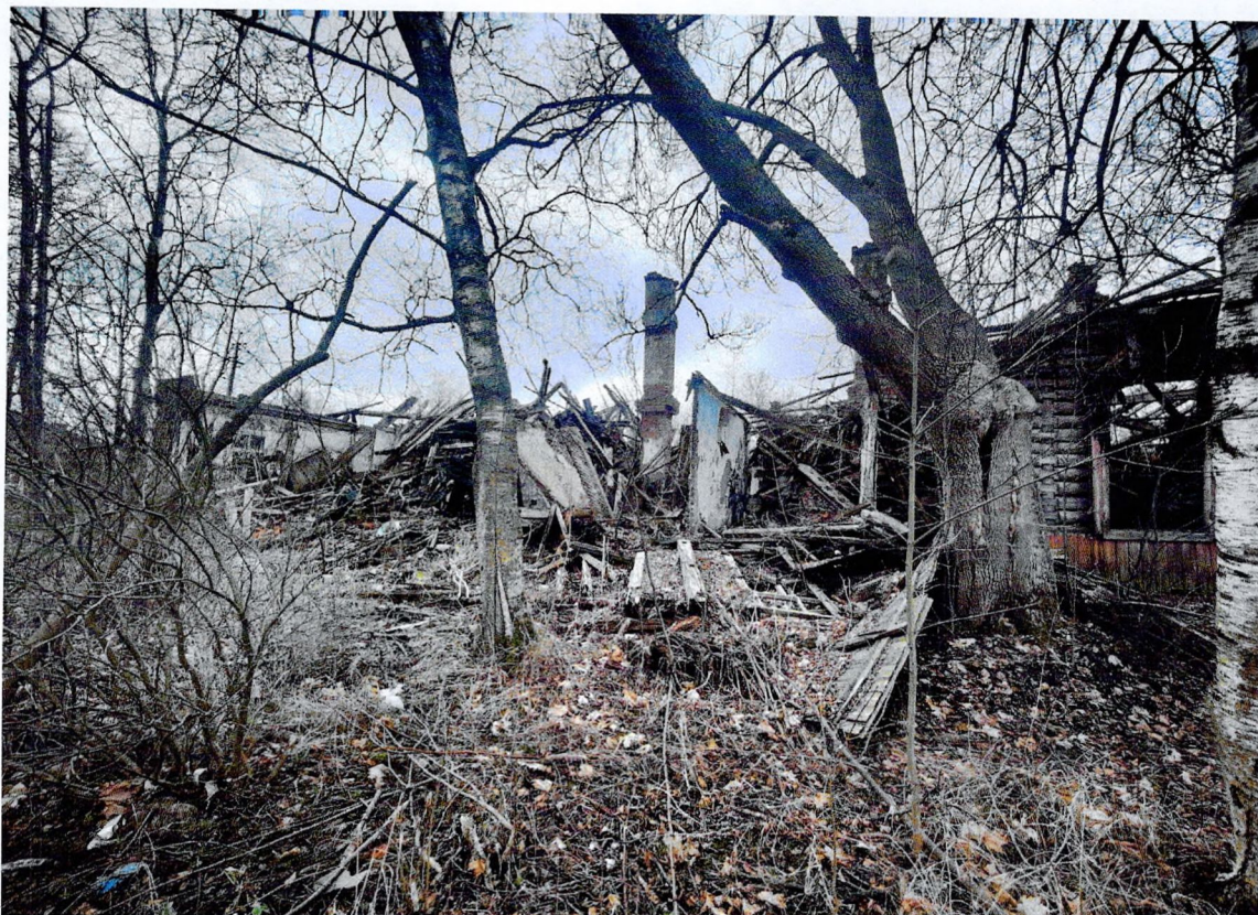
Фото 3. Фрагмент северного фасада. Скопление разрушенных строительных конструкций. Сохранились кирпичные дымоходы, фрагменты деревянных перегородок обшитые дранкой. На прилегающей территории прорастают деревья и кустарники.
