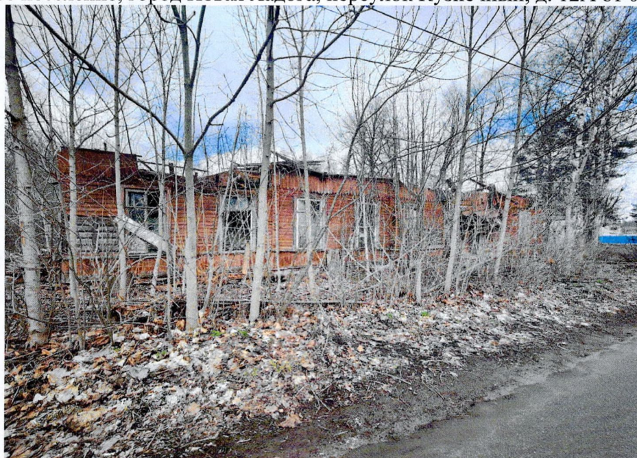
Фото 1. Восточный фасад (со стороны Кузнечного переулка). Фасады окрашены в светло-коричневый цвет. Утрата конструкций крыши в результате пожара по всей площади здания. Зарастание прилегающей территории к зданию.
