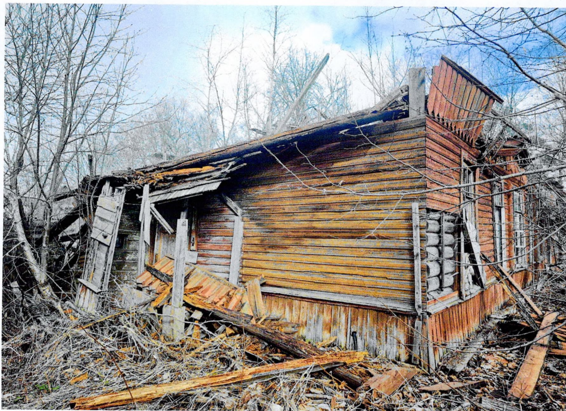
Фото 13. Южный фасад. Разрушение и утраты конструкций.
