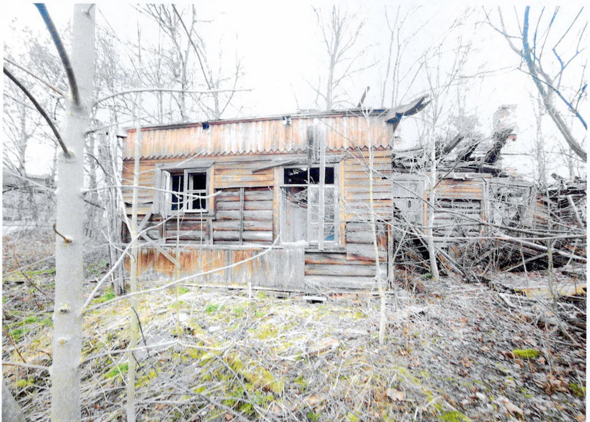
Фото 8. Фрагмент юго-западного фасада. Частичная утрата обшивки фасада.
