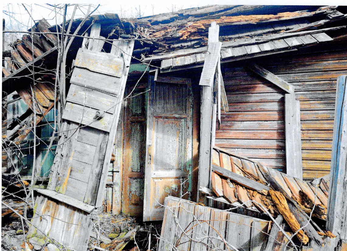
Фото 14. Фрагмент южного фасада. Просматриваются фрагменты утраченного крыльца: деревянные стойки, деревянная площадка со ступенями, деревянный козырек со сплошной обрешеткой. Дверь двойная филенчатая, окрашенная в светло-зеленый цвет.
