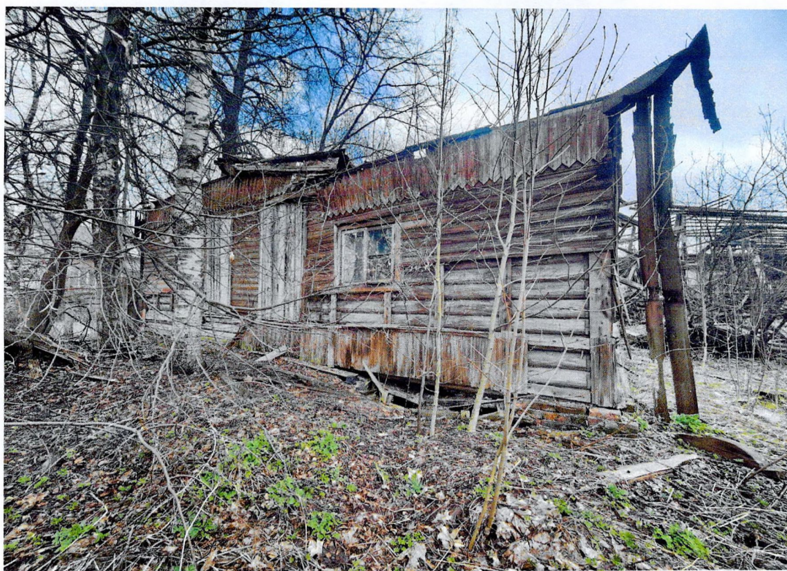
Фото 6. Фрагмент западного фасада. Частичные утраты обшивки фасада. Два оконных заполнения защиты досками.
