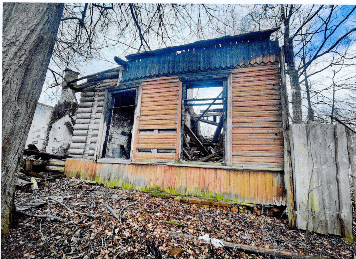
Фото 5. Фрагмент северного фасада. Утрата оконных заполнений. Частичные утраты и обугливание обшивки фасада. Просматривается кирпичный цоколь.
