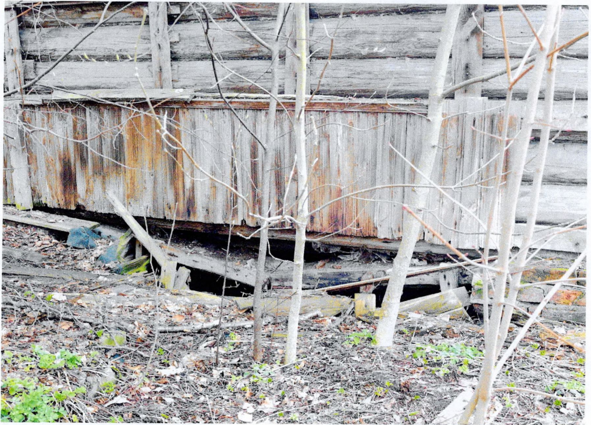
Фото 7. Фрагмент северо-западного фасада. Сквозное повреждение участка цоколя, просматривается техподполье.
