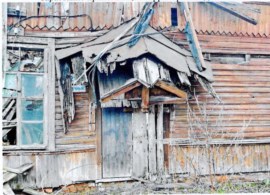
Фото 2. Фрагмент восточного фасада. Разрушение козырька над входом в здание. Цоколь кирпичный.
