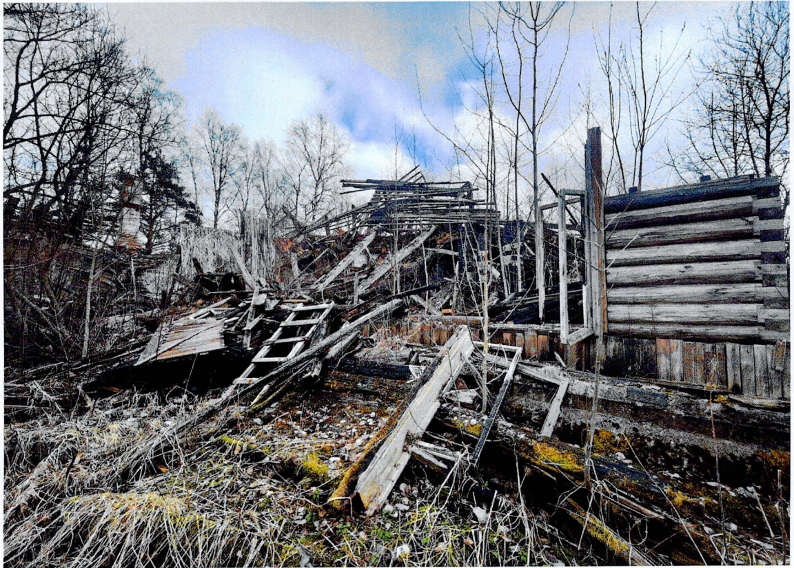
Фото 11. Фрагмент юго-западного фасада. Утрата конструкций в результате пожара.
