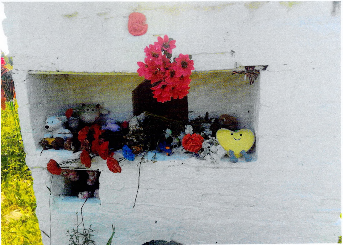
Фото 18. Печь №1. Вид спереди.
