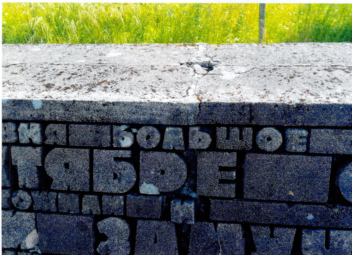
Фото 10. Стела, расположенная слева от скульптуры партизана. Трещины в конструкции, образования мха.
