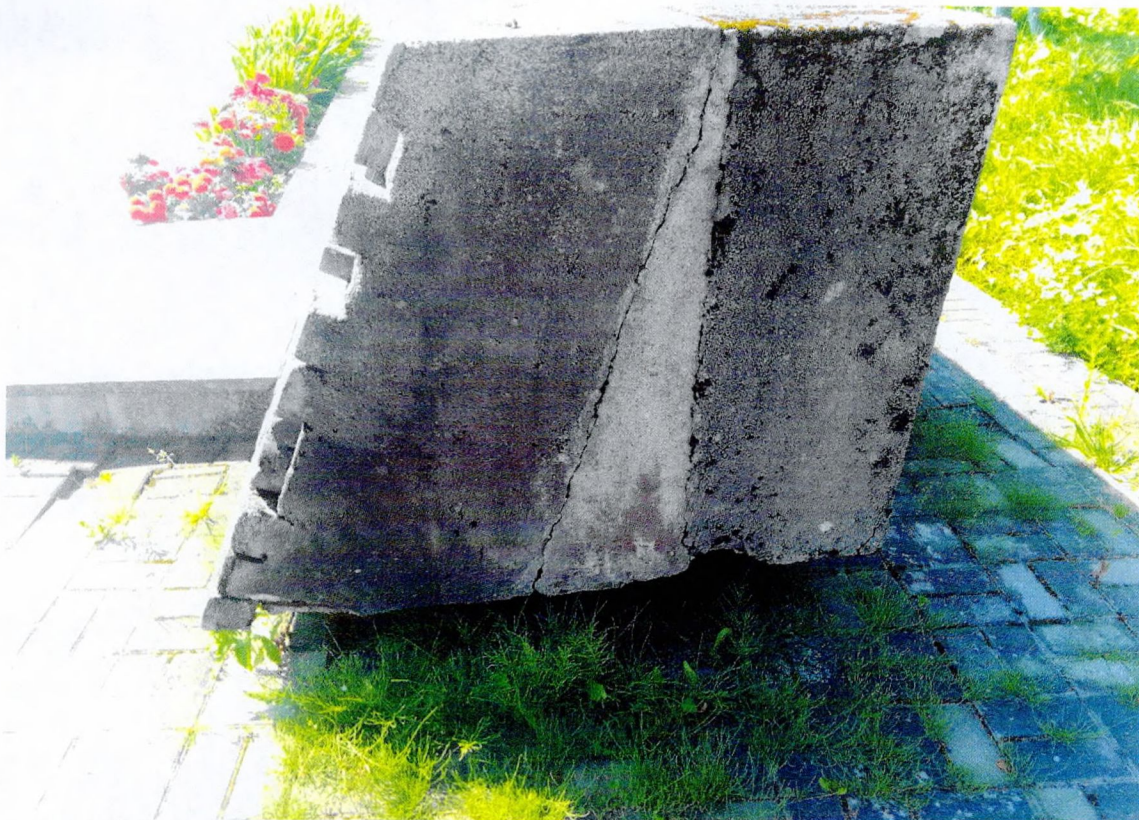
Фото 13. Стела, расположенная справа от скульптуры партизана. Трещины в конструкции, образования мха, прорастание растений в отместке.
