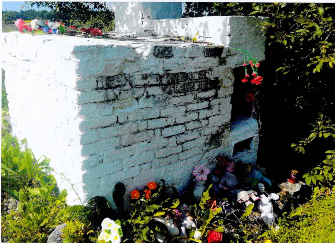
Фото 27. Печь №4. Биоповреждение кладки.
