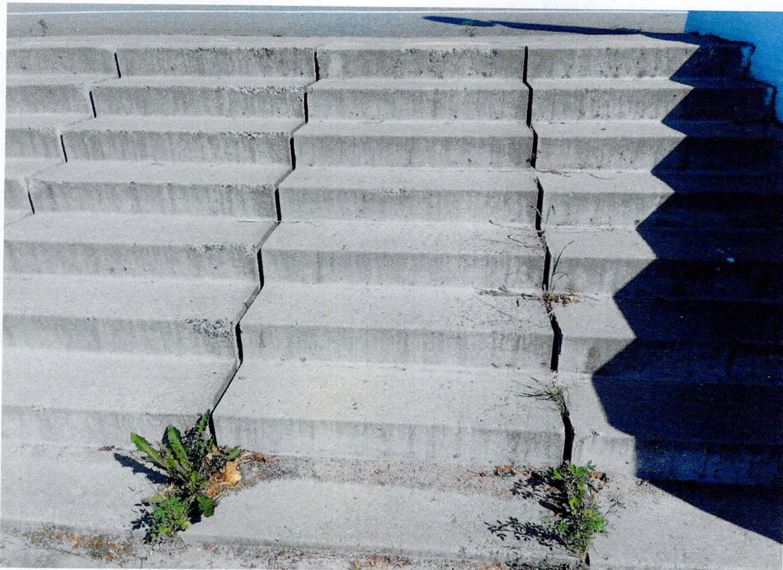
Фото 15. Лестница с северной стороны территории. Отсутствие заполнения швов между ступенями, сколы бетона, прорастание растений.
