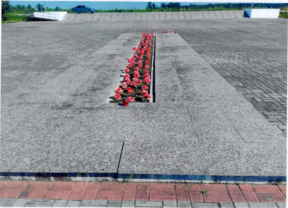
Фото 7. Могильный холм. Расхождение швов между плитами, высолы на плитах.
