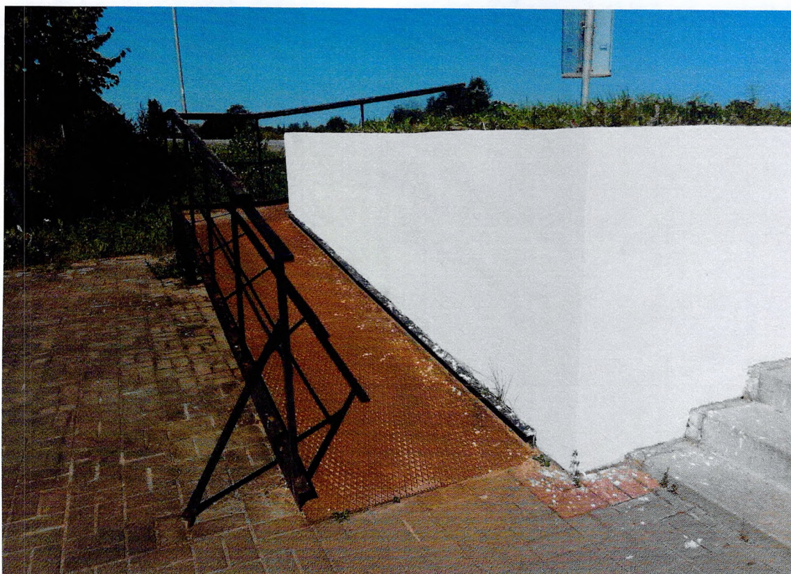
Фото 16. Пандус с северной стороны территории. Коррозия металлических конструкций, рассыхание древесины поручня.
