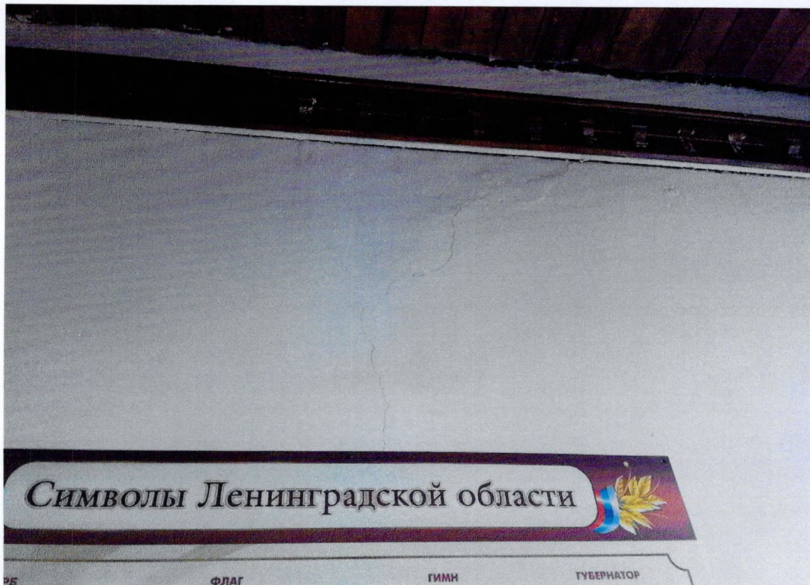
Фото 37. Третий этаж. Трещина по стене.
