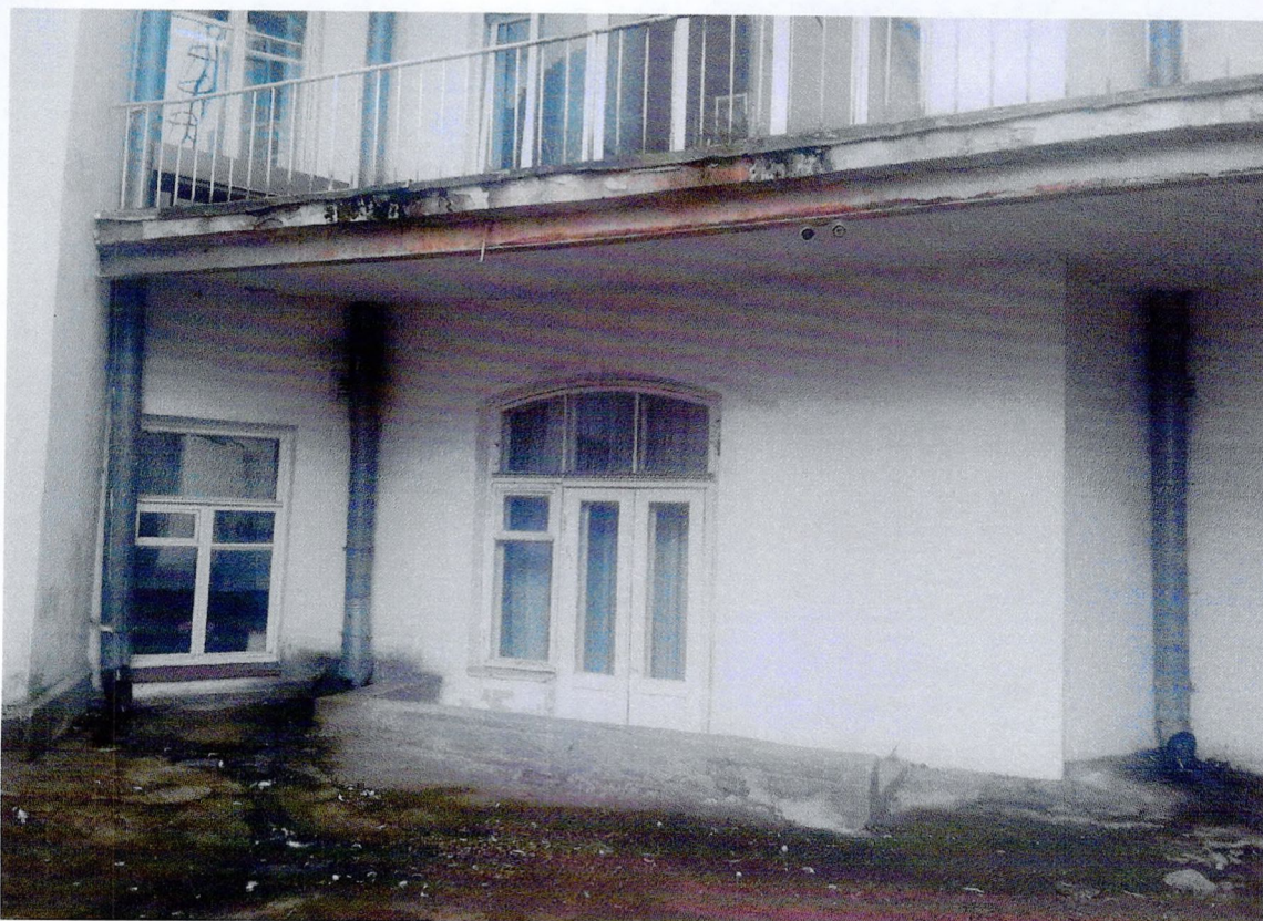
Фото 11. Фрагмент дворового фасада. Повреждение отмостки, нарушение водоотведения от стен здания.
