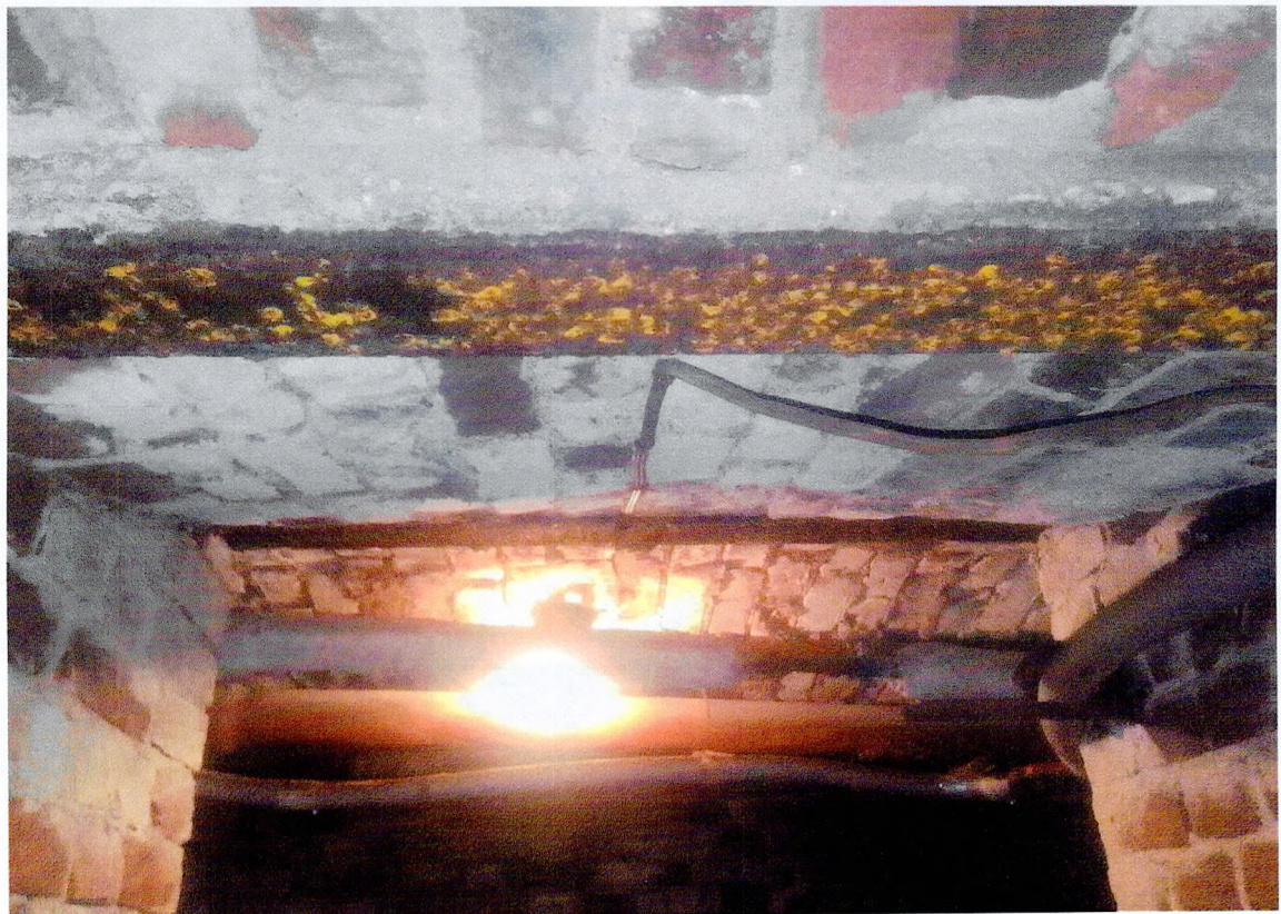
Фото 18. Подвал. Коррозия металлических балок.
