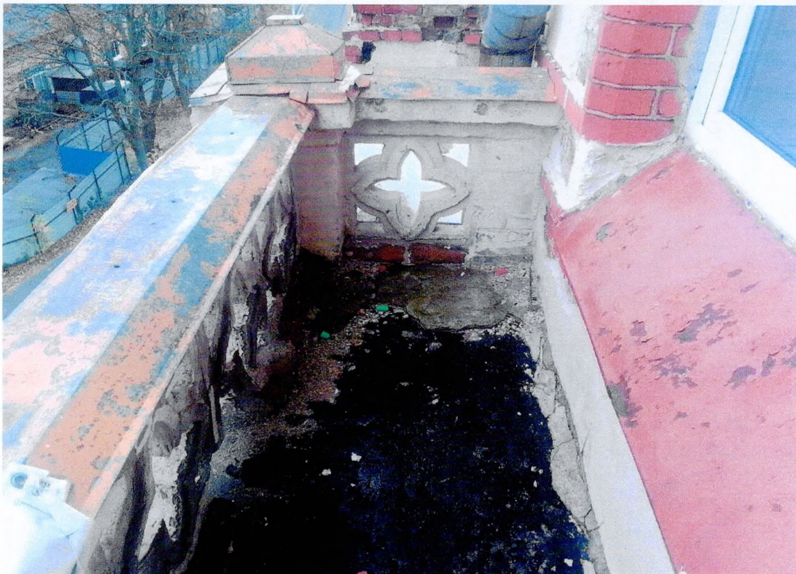
Фото 33. Третий этаж. Разрушение стяжки балконной плиты уличного фасада.
