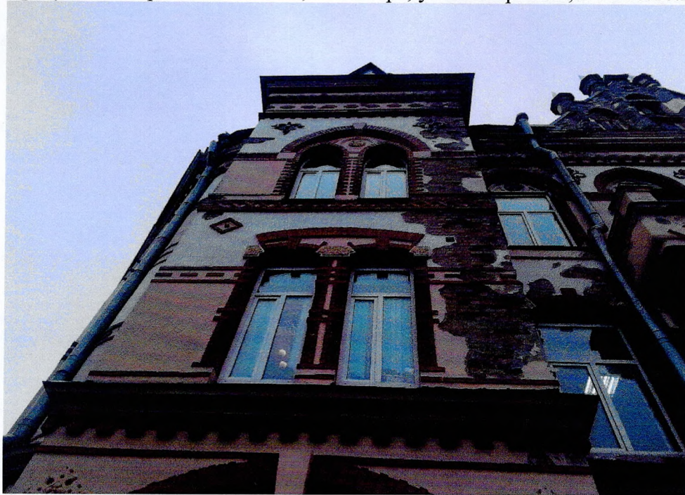
Фото 1. Фрагмент западного уличного фасада. Фрагментарно демонтирован отделочный слой поверхности стен.
