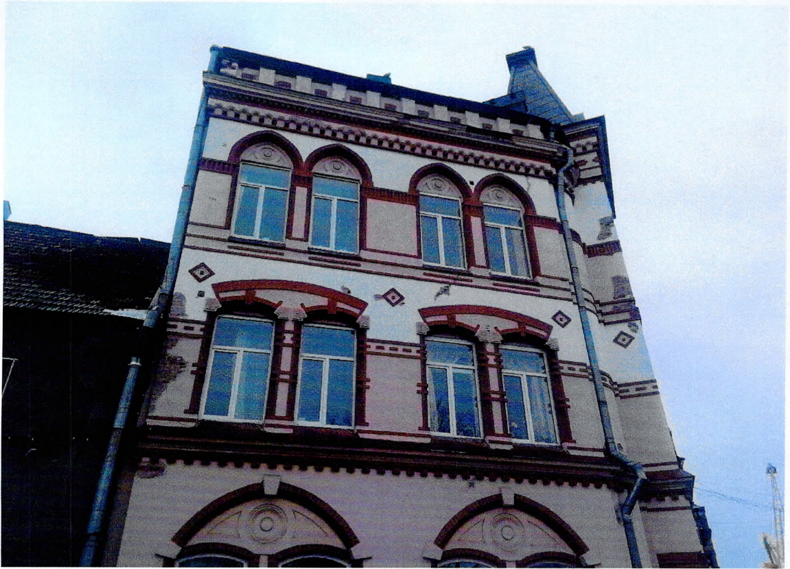
Фото 9. Фрагмент северного уличного фасада. Фрагментарно демонтирован отделочный слой поверхности стен.
