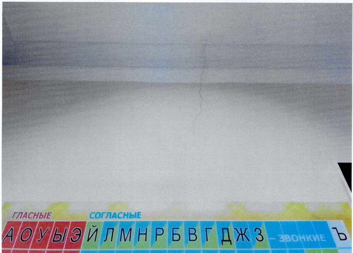
Фото 22. Первый этаж. Трещина по стене и перекрытию.
