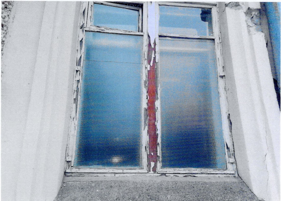
Фото 4. Фрагмент западного уличного фасада. Деревянное оконное заполнение, рассыхание древесины.
