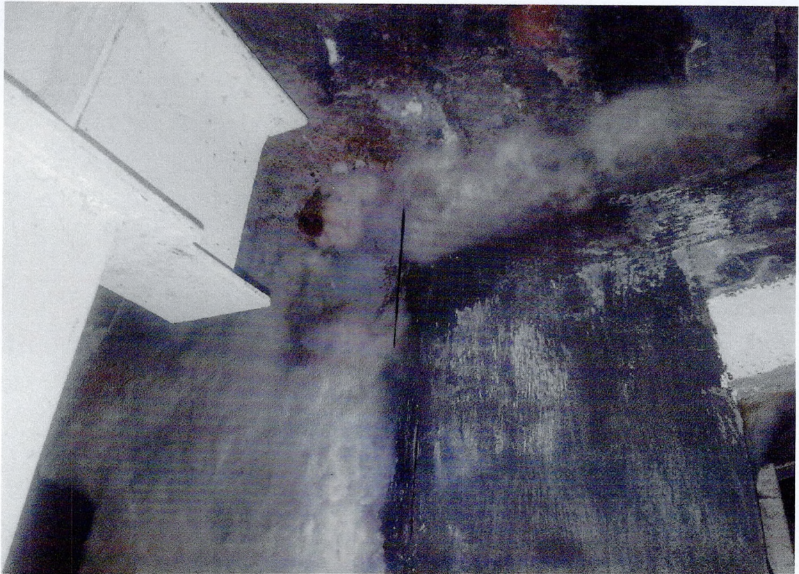
Фото 19. Подвал. Высолы на стенах.
