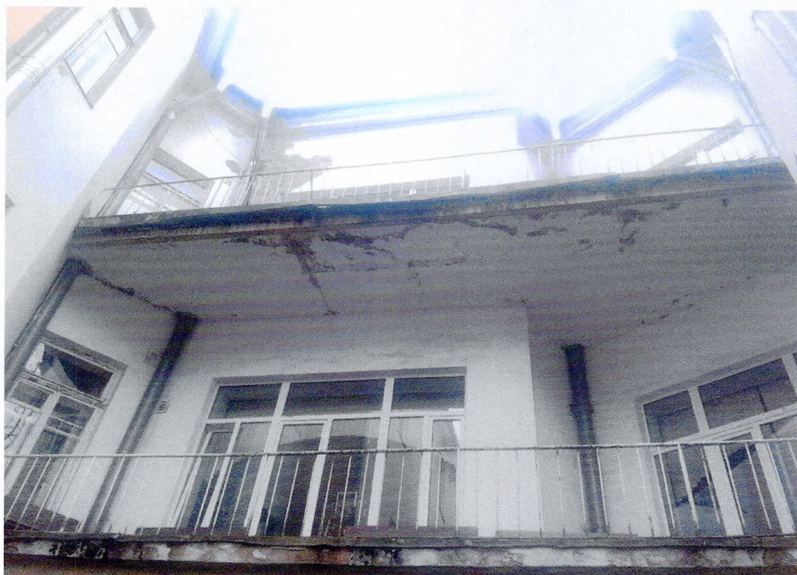
Фото 12. Фрагмент дворового фасада. Утраты отделочного слоя балконов, биоповреждения.
