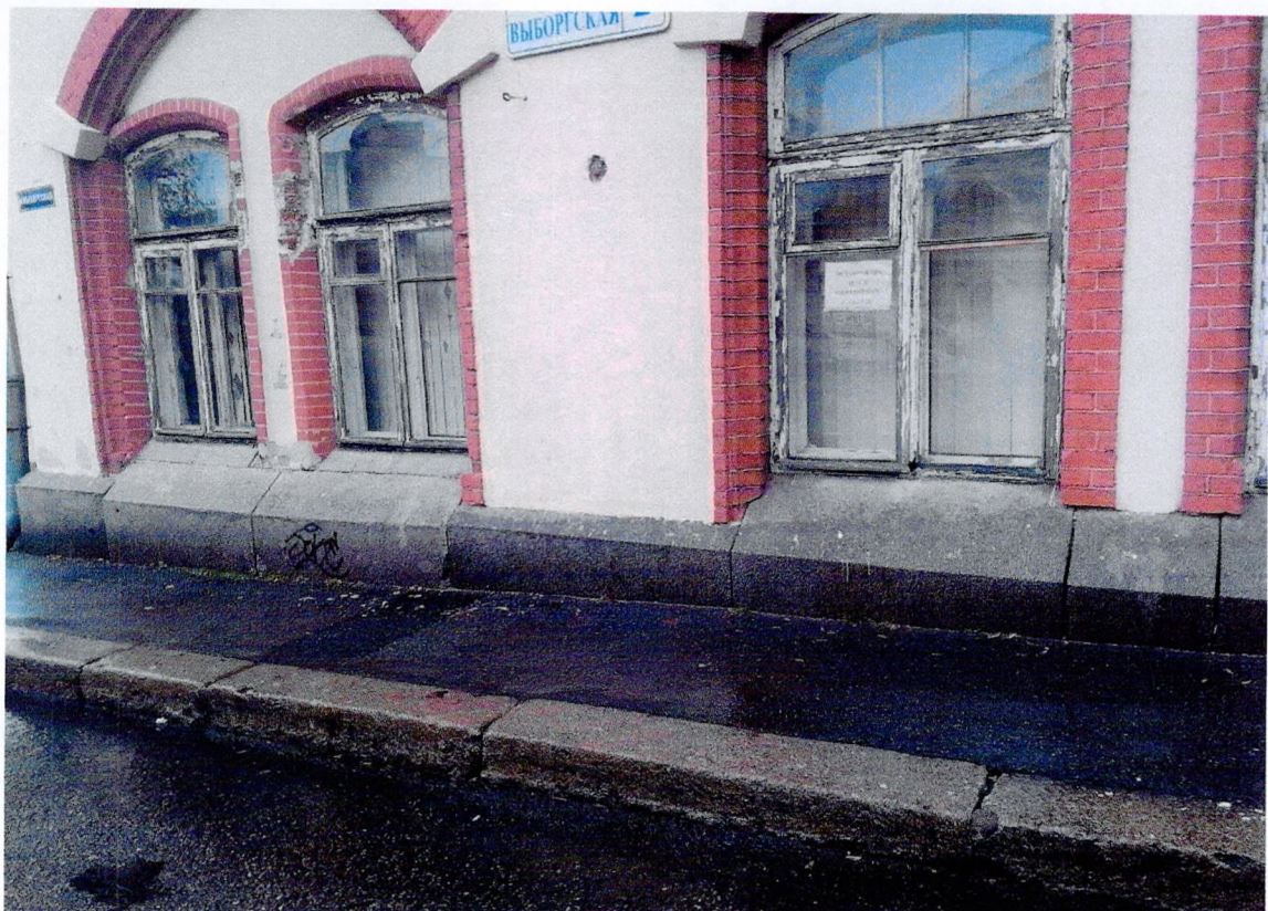
Фото 8. Фрагмент южного уличного фасада. Деревянные оконные заполнения, рассыхание древесины.
