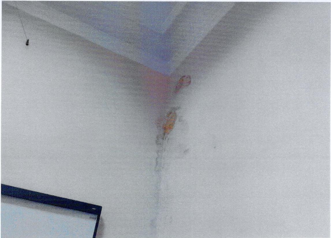
Фото 23. Первый этаж. Следы намокания стен.
