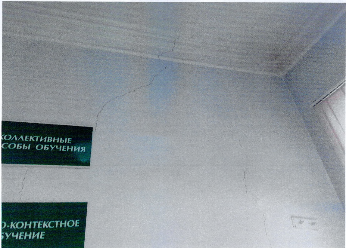
Фото 25. Второй этаж. Трещина по стене и перекрытию.
