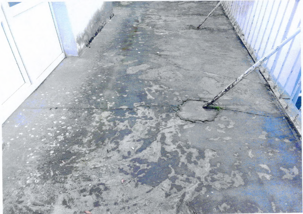
Фото 32. Третий этаж. Разрушение защитной стяжки балконной плиты дворового фасада.
