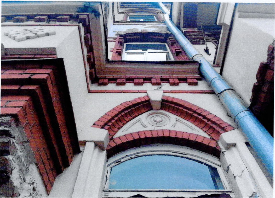
Фото 3. Фрагмент западного уличного фасада. Трещины по отделочному слою декоративных элементов.
