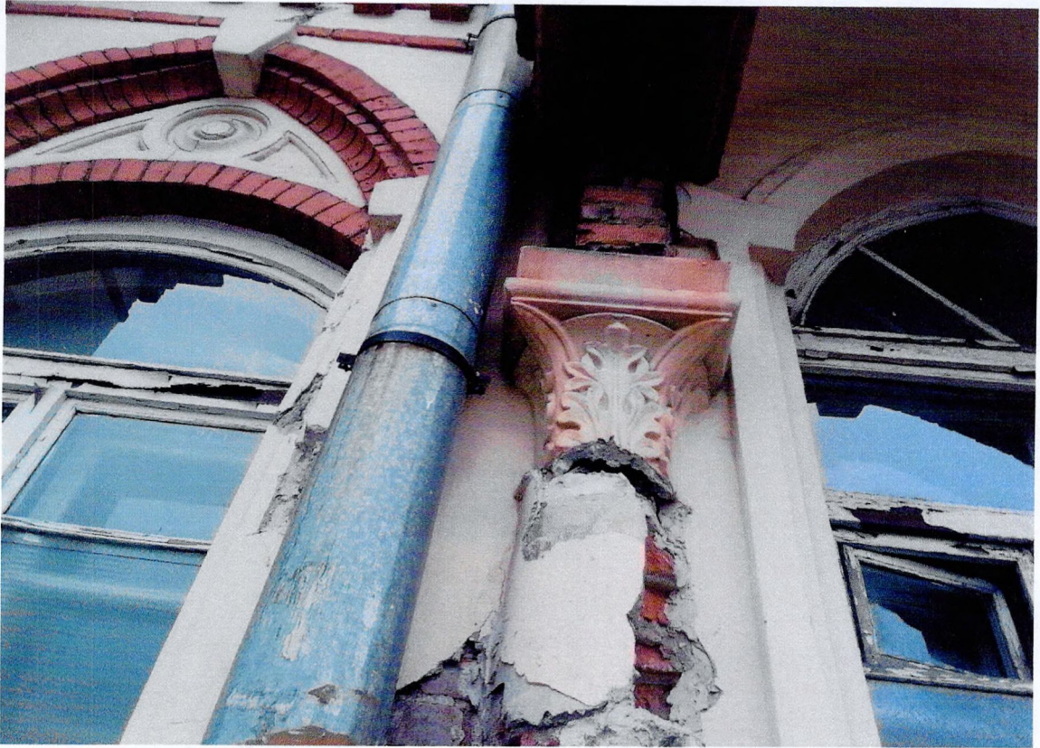
Фото 5. Фрагмент западного уличного фасада. Разрушение отделочного слоя полуколонн.
