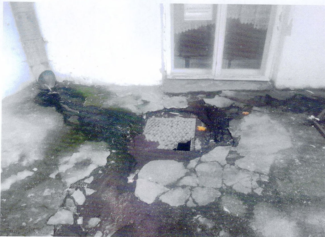
Фото 13. Фрагмент дворовой территории. Разрушение отмостки, нарушение уклона, биоповреждения.
