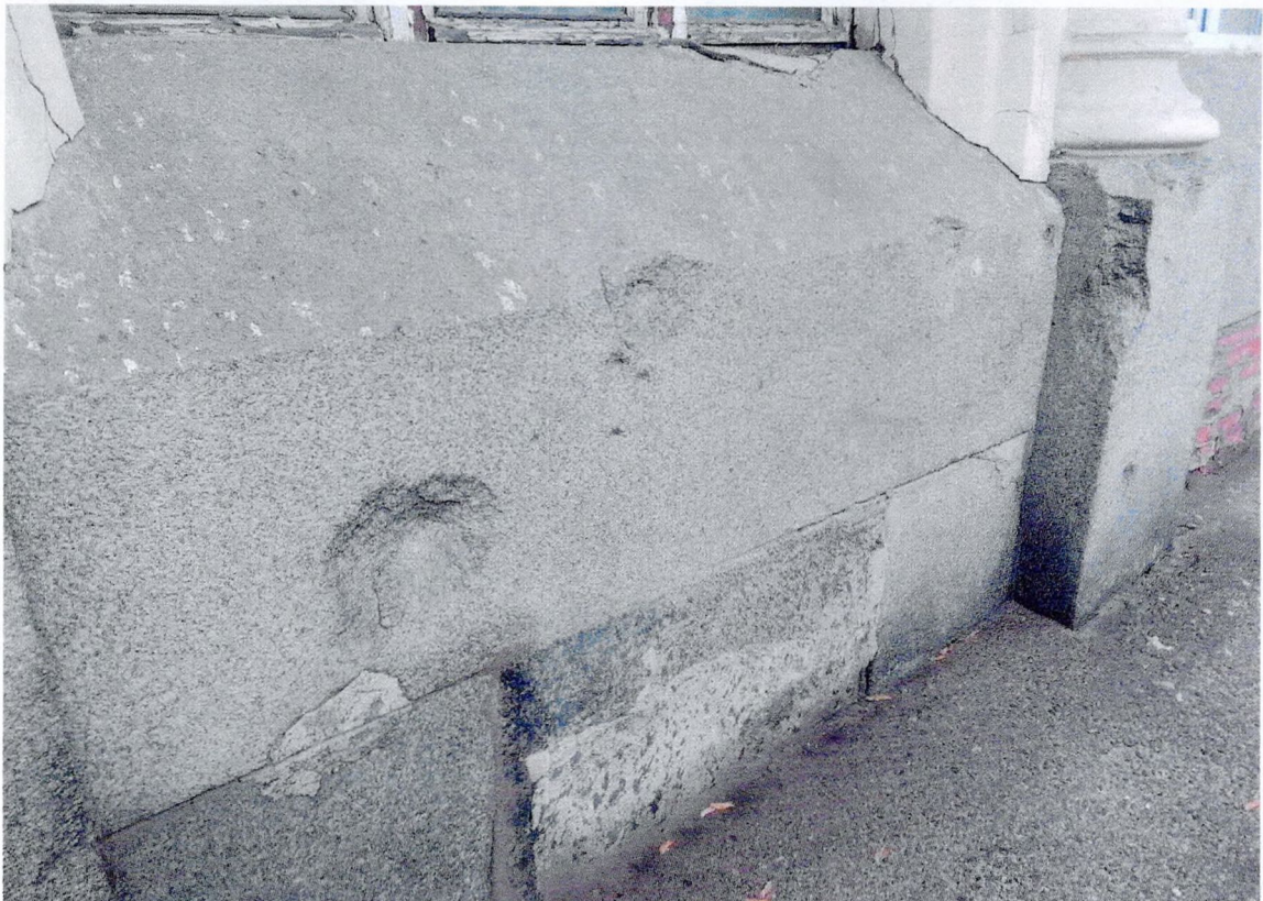
Фото 6. Фрагмент западного уличного фасада. Сколы гранитных блоков цоколя.
