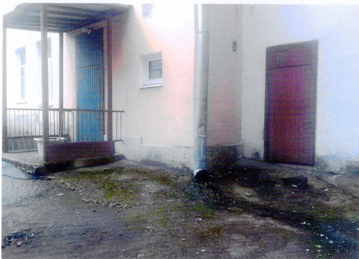
Фото 14. Фрагмент дворовой территории. Разрушение отмостки, нарушение уклона, биоповреждения.
