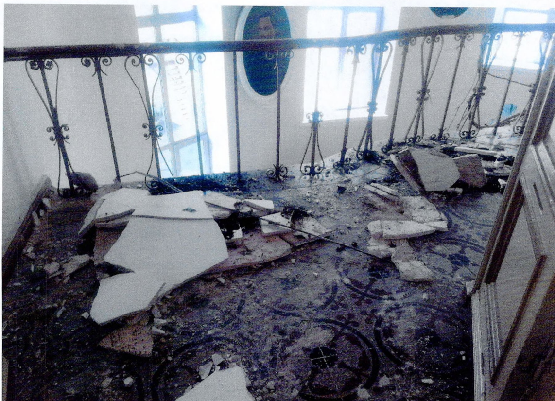
Фото 30. Третий этаж. Центральная лестница. Фрагменты обрушенного штукатурного слоя. Нанесение штукатурного слоя производилось по металлической сетке толстым слоем.
