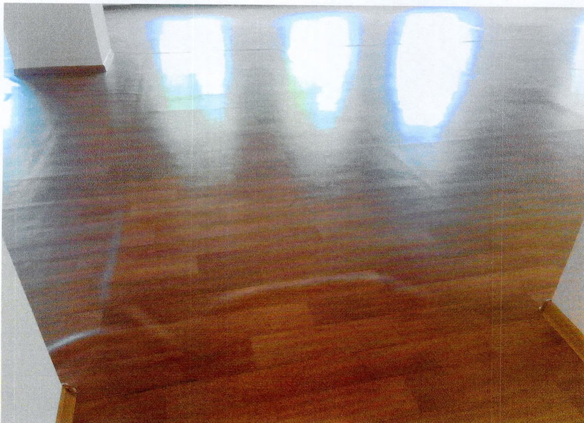
Фото 29. Внутренние помещения. Вздутия рулонного покрытия пола холла второго этажа.
