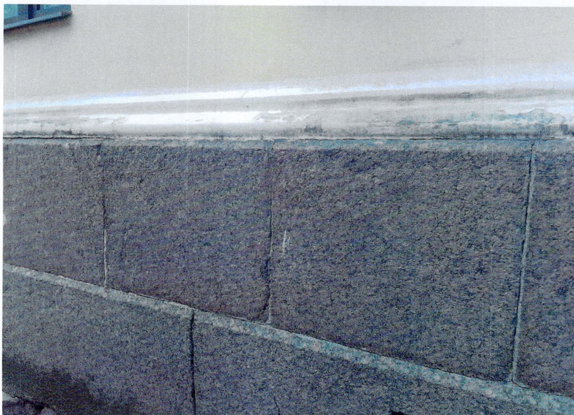
Фото 12. Фрагмент северо-восточного фасада. Отслоение отделочного слоя тяги над цоколем.
