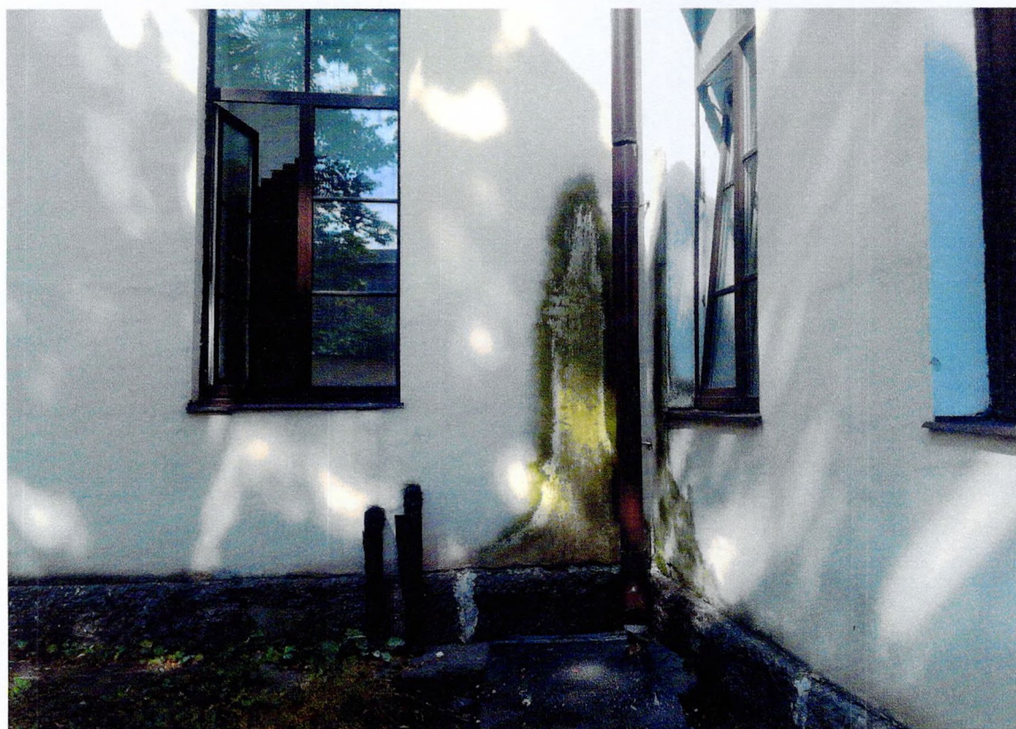
Фото 20. Угол юго-западного фасада дворового центрального ризалита. Разрыв водосточной трубы. Биоповреждения фасадной поверхности.
