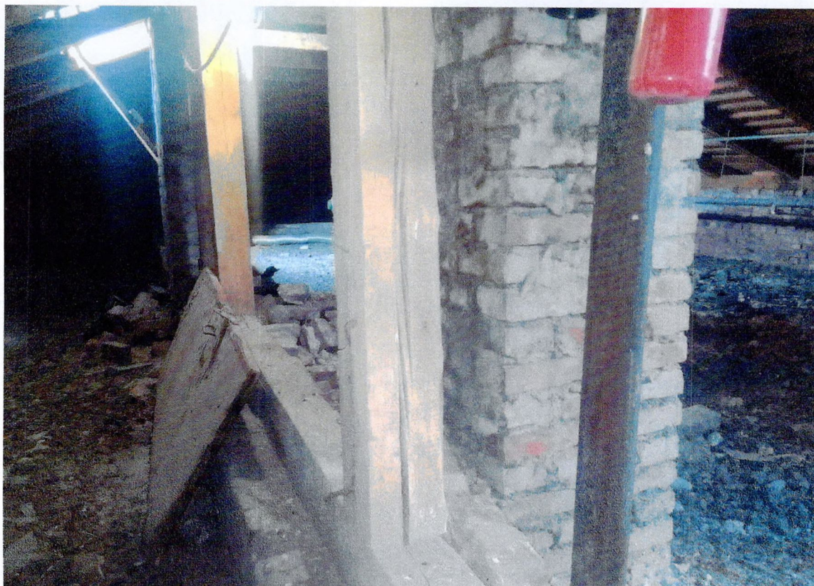
Фото 38. Трещины в конструкциях стропильной системы.
