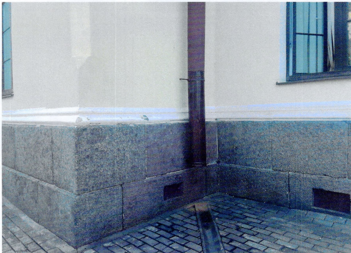
Фото 7. Фрагмент северо-западного фасада. Отсутствие колена водосточной трубы.
