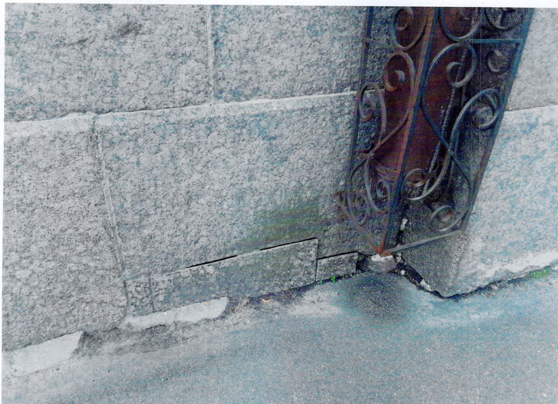
Фото 11. Фрагмент северо-восточного фасада. Отсутствие колена водосточной трубы. Следы ремонта цоколя путем вставок гранитных плиток.
