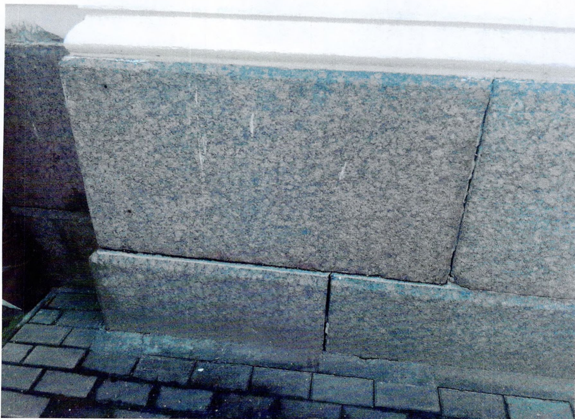
Фото 5. Фрагмент северо-западного фасада. Утраты шовного раствора между гранитными блоками цоколя.
