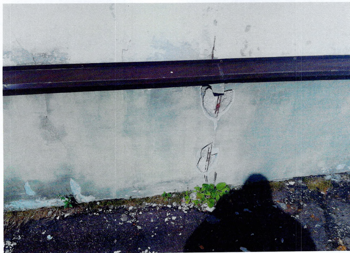
Фото 14. Фрагмент юго-восточного дворового фасада. Отслоение штукатурного слоя цоколя.
