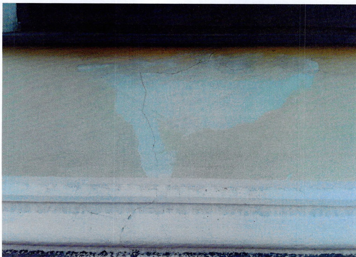
Фото 4. Фрагмент северо-западного фасада. Трещина в штукатурном слое.
