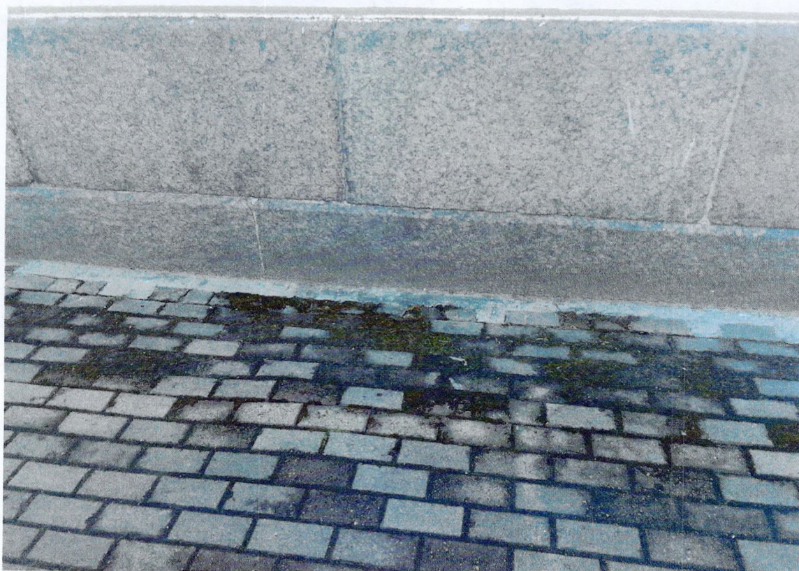
Фото 3. Фрагмент северо-западного фасада. Биоповреждения отмоски.
