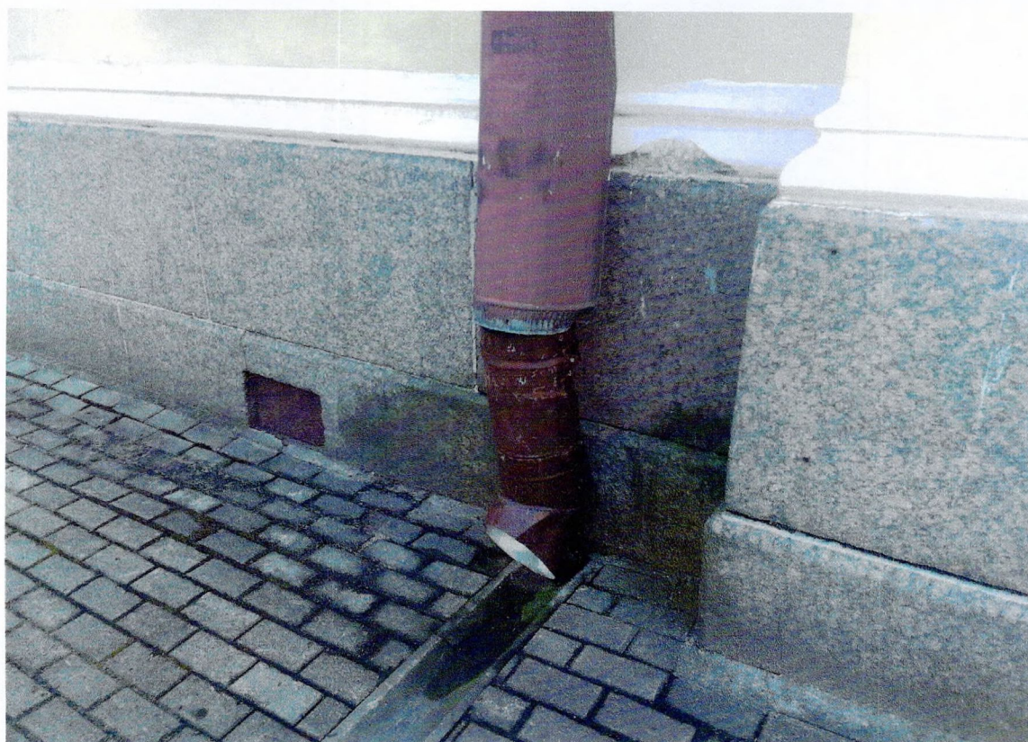
Фото 6. Фрагмент северо-западного фасада. Диаметр колена водосточной трубы не соответствует основному диаметру трубы. Биоповреждение цоколя и водоотводного лотка.
