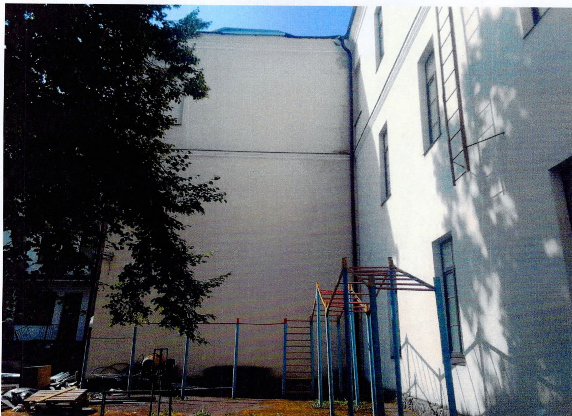
Фото 21. Дворовой северо-восточный фасад южного ризалита. Биоповреждения.
