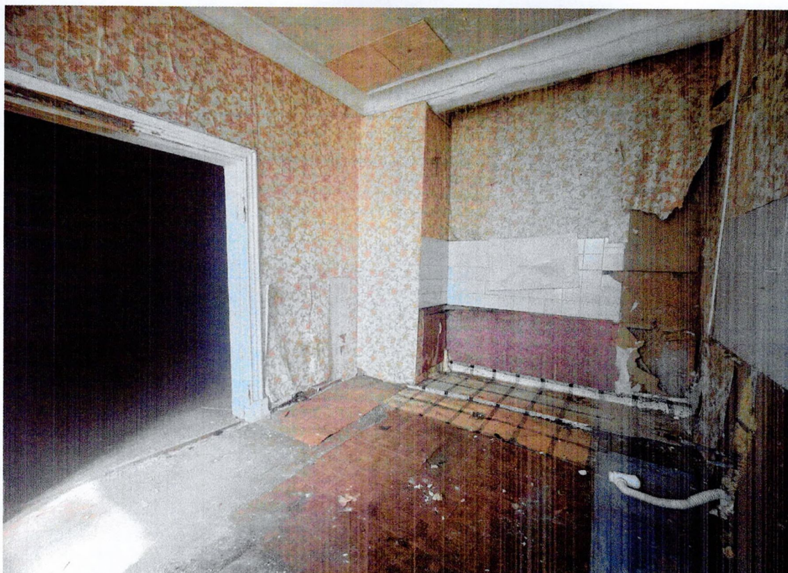
Фото 23. Внутреннее помещение. Износ отделочных покрытий. Утрата инженерных систем.
