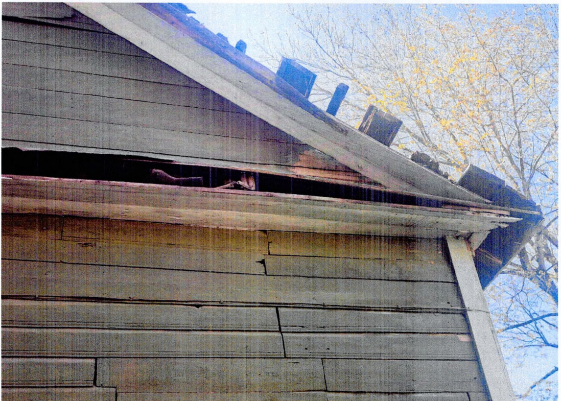
Фото 6. Фрагмент северного фасада. Утрата части декора фронтона, обрешетки и покрытия кровли.
