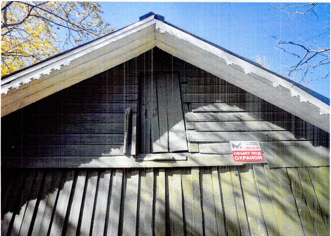
Фото 12. Фрагмент восточного фасада. Утрата части резного декора в обрамлении фронтона.
