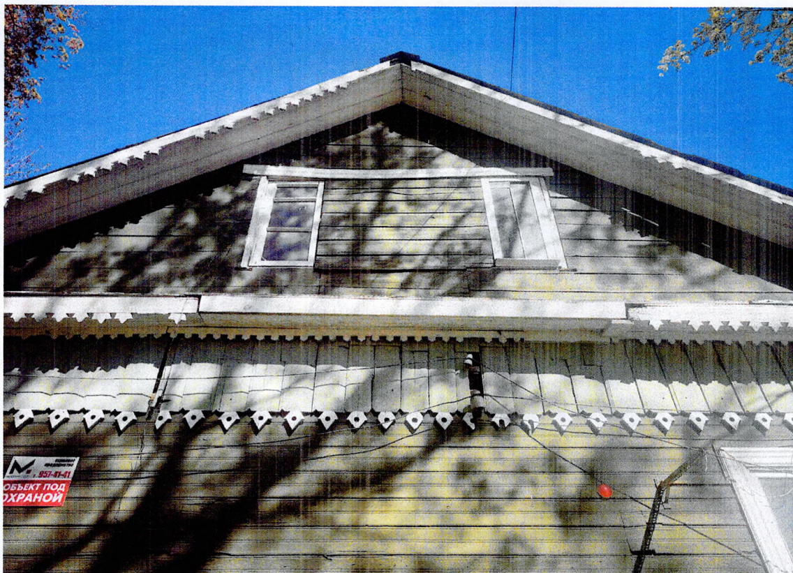
Фото 19. Фрагмент южного фасада. Утрата части резного декора в обрамлении фронтона.
