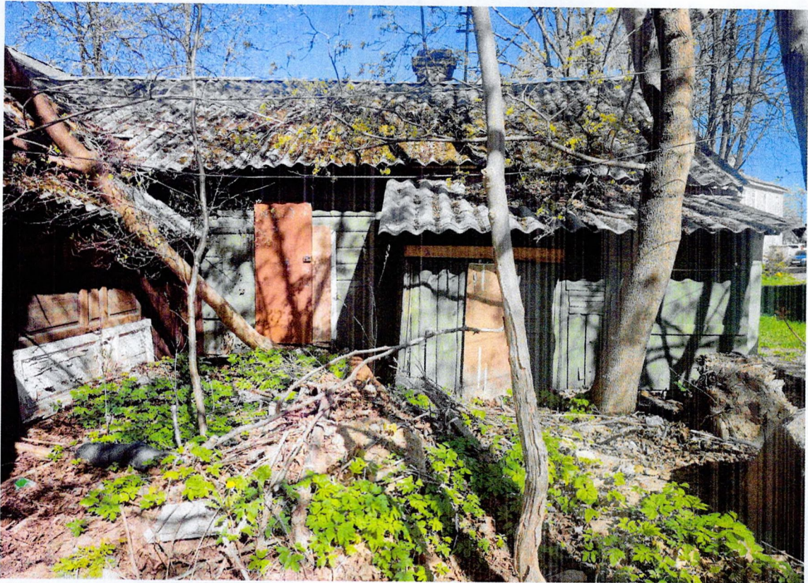
Фото 15. Фрагмент южного фасада. Биоповреждения кровли. Деревья и растительность в зоне примыкания к стенам.
