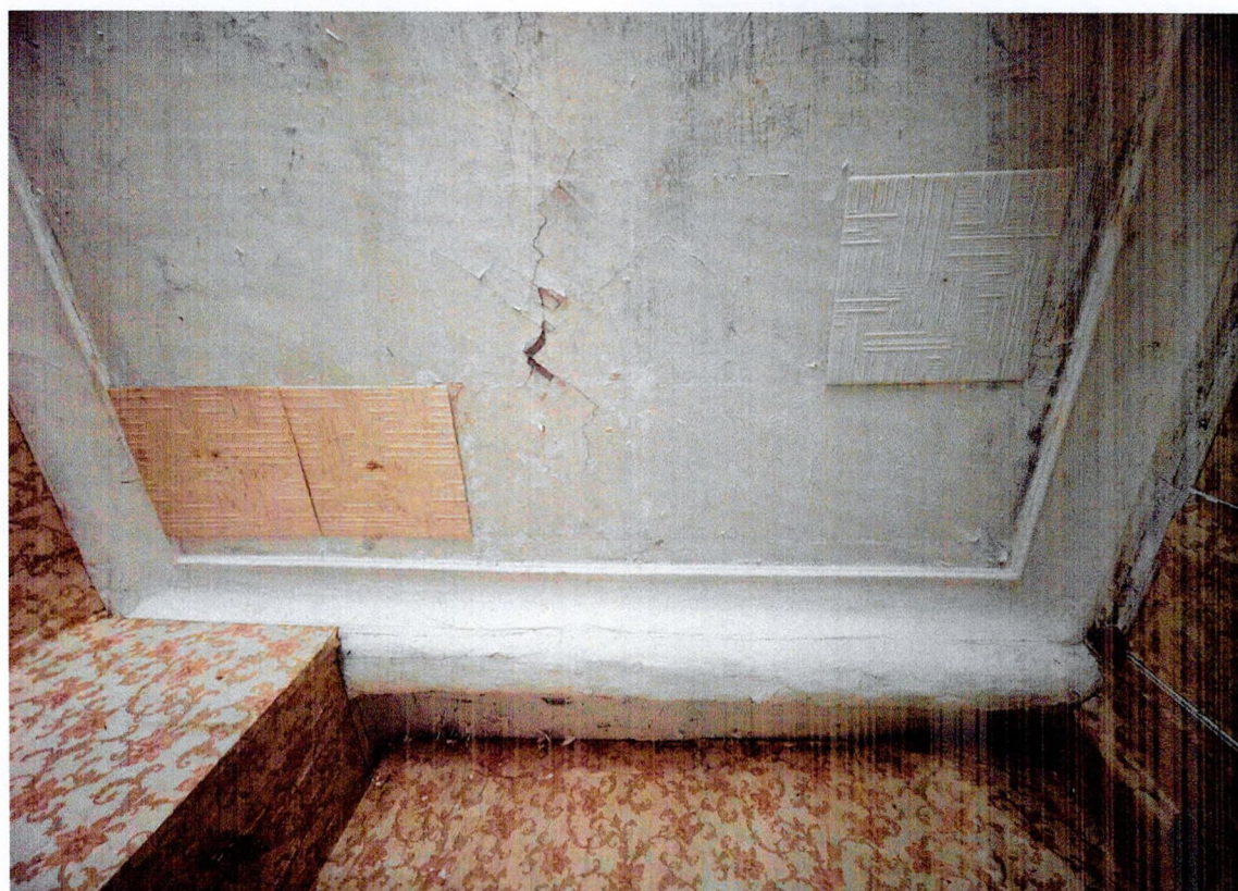
Фото 24. Внутреннее помещение. Трещины по отделочному слою деревянного перекрытия.
