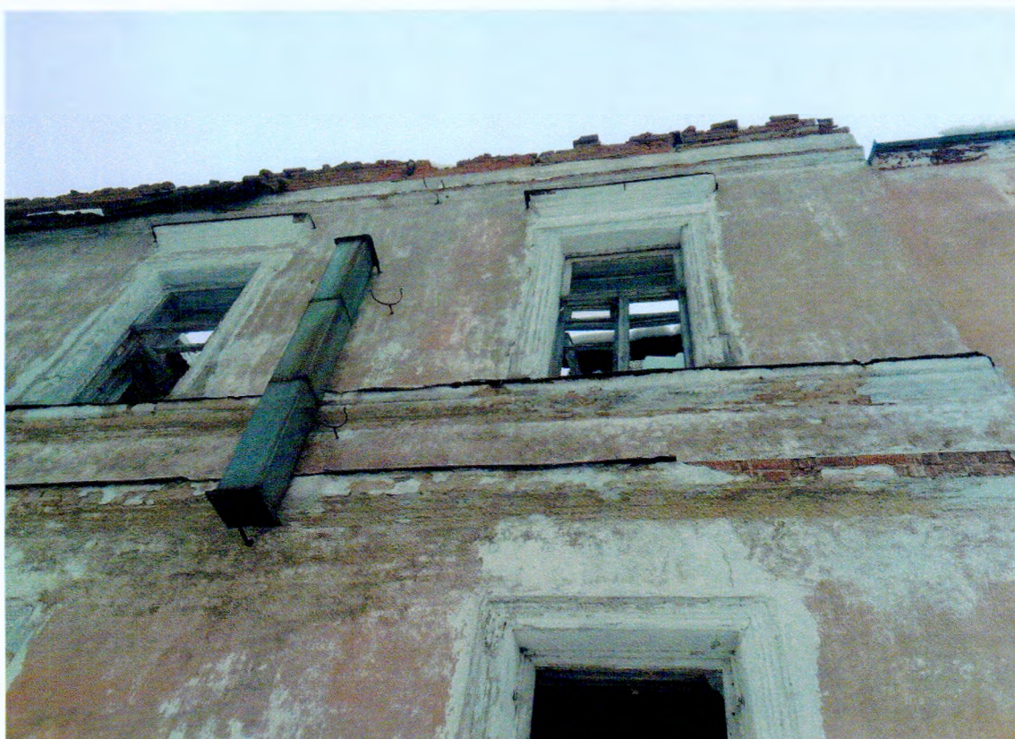
Фото 22. Фрагмент юго-восточного фасада. Разрушение кирпичной кладки в верхней части стены.
