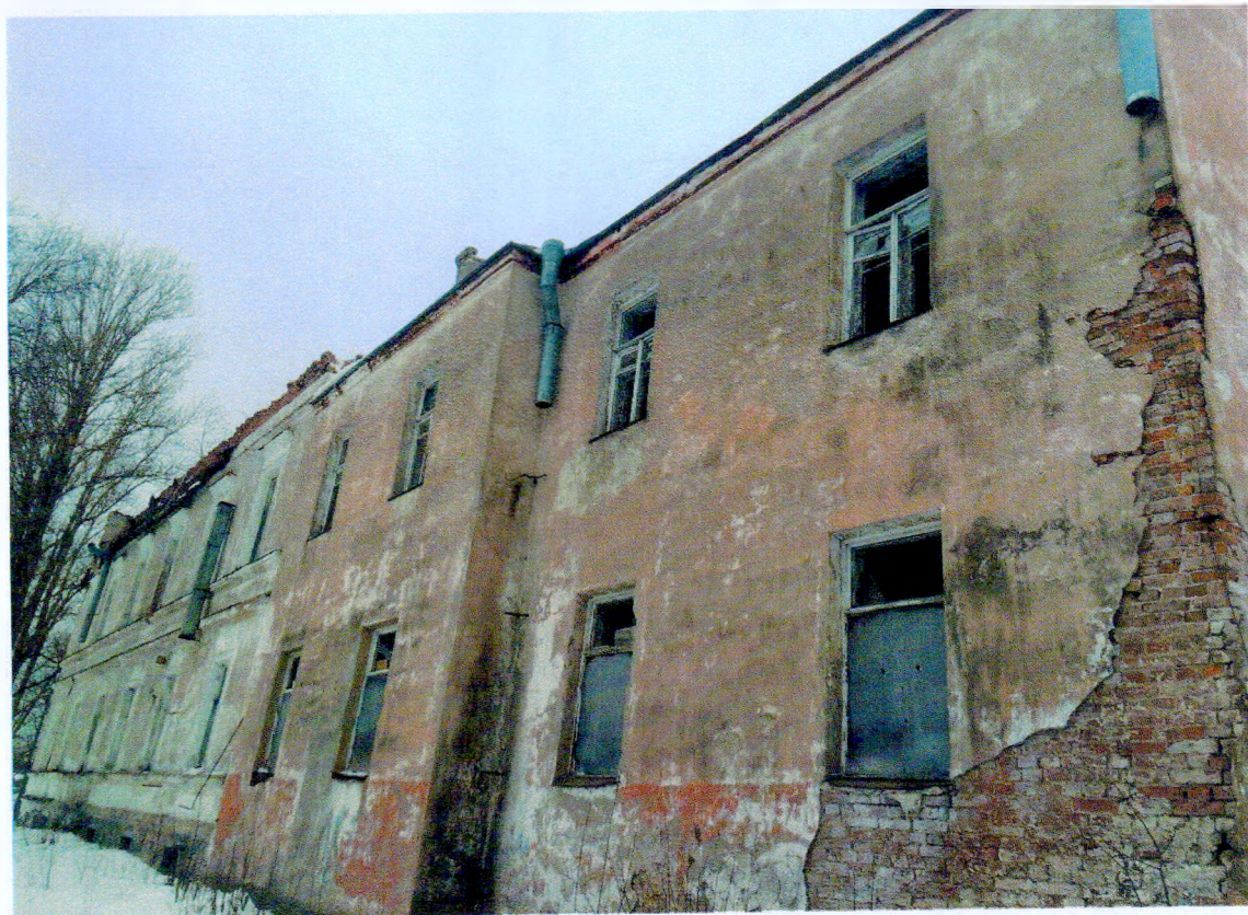
Фото 19. Вид на восточный фасад. Утраты штукатурного слоя.
