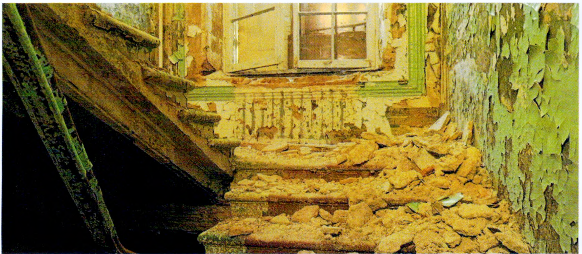
Фото 32. Вид на главную лестницу. Конструкция – каменные ступени, уложенные по металлическим косоурам. Ограждение лестницы утрачено.
