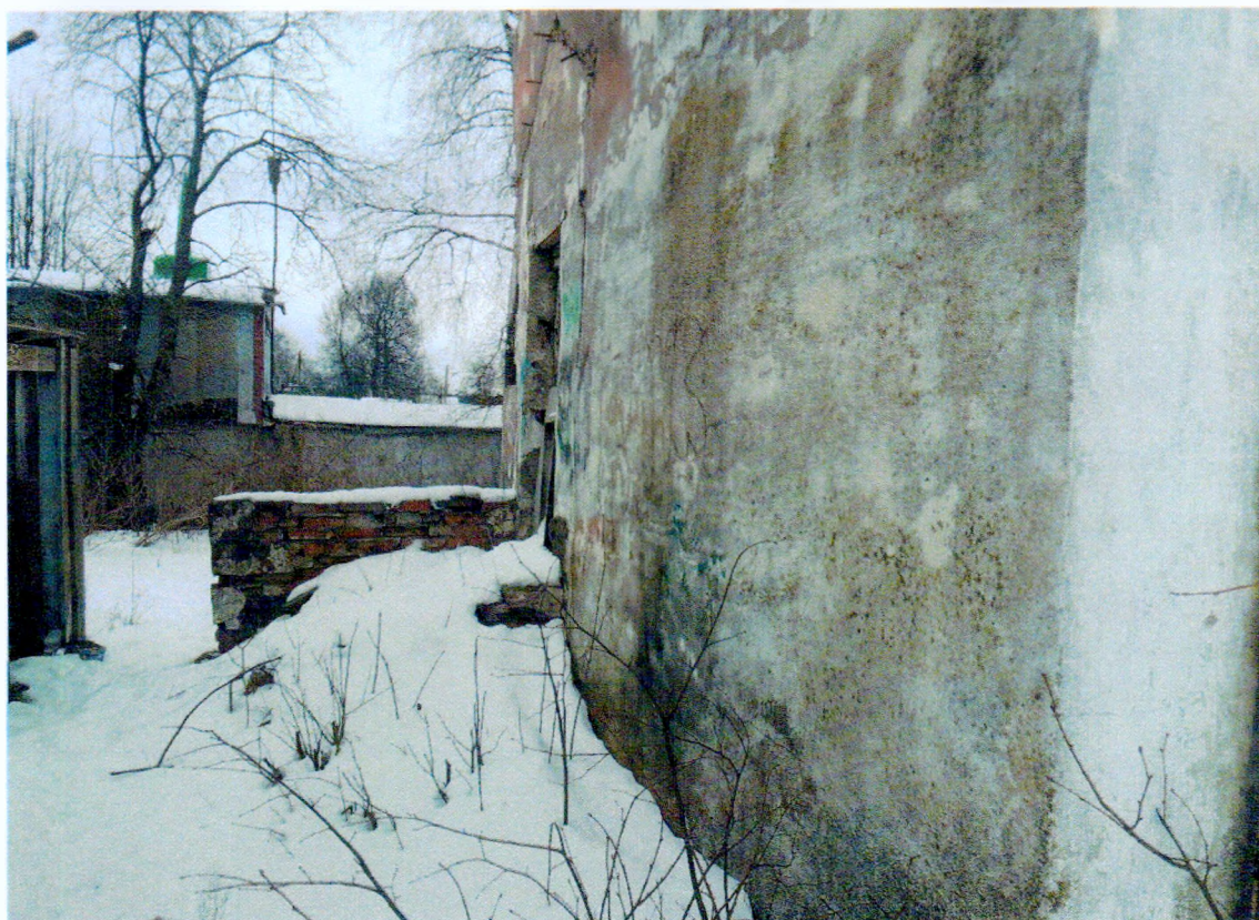
Фото 17. Фрагмент северного фасада. Вздутие штукатурного слоя.
