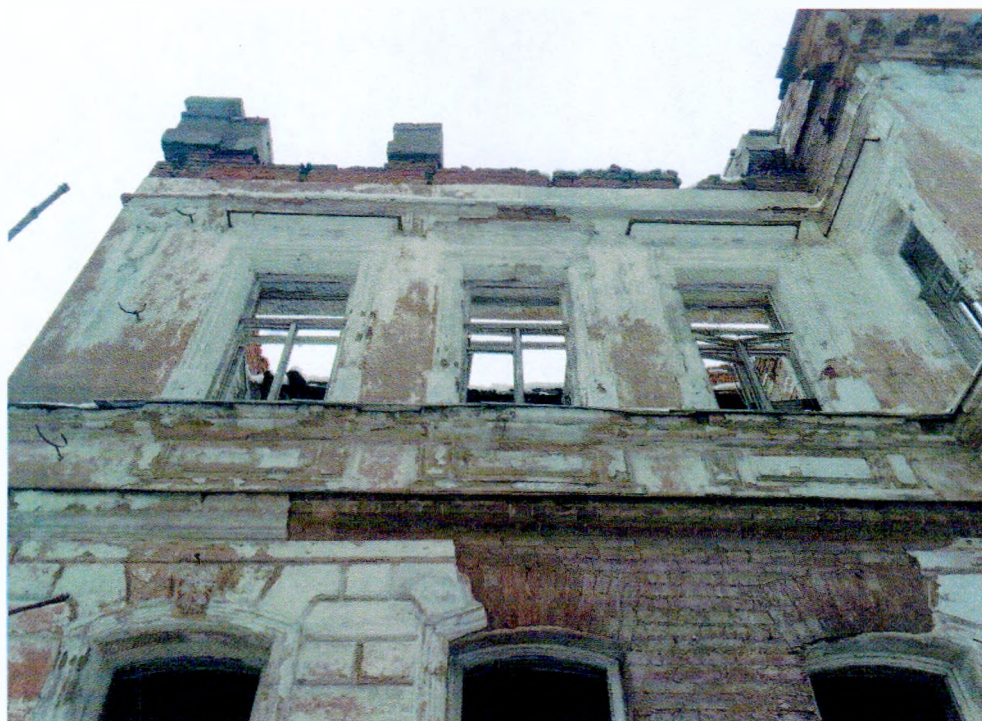
Фото 3. Фрагмент юго-западного фасада. Вид на оконные проемы 2 этажа. Прямоугольные оконные проемы имеют декор в виде штукатурных профилированных сандриков. Разрушение кирпичной кладки в верхней части стены.
