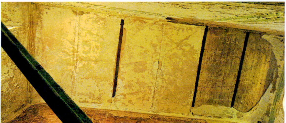
Фото 33. Вид на перекрытие над помещением главной лестницы. Перекрытие выполнено по металлическим балкам двутаврового сечения с бетонным заполнением. Наблюдается прогиб перекрытия и коррозия поверхности металла балок.
