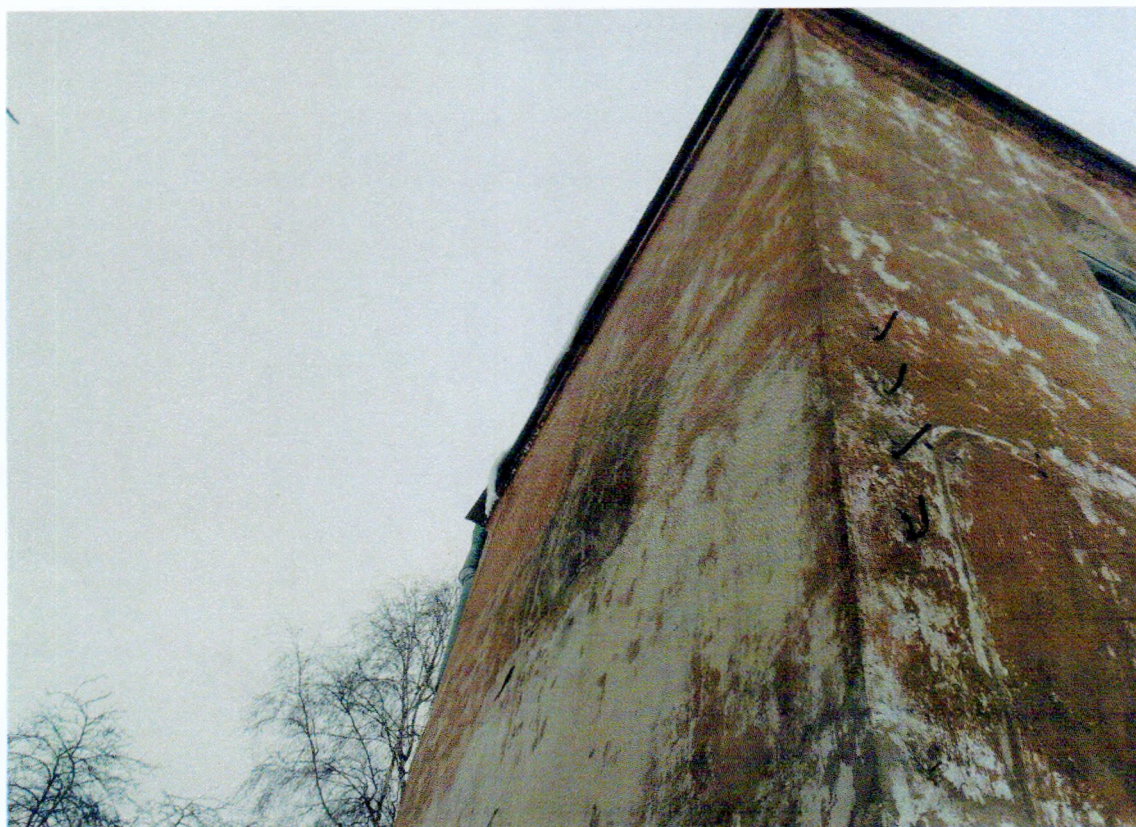
Фото 16. Фрагмент северного фасада. Утраты штукатурного слоя.
