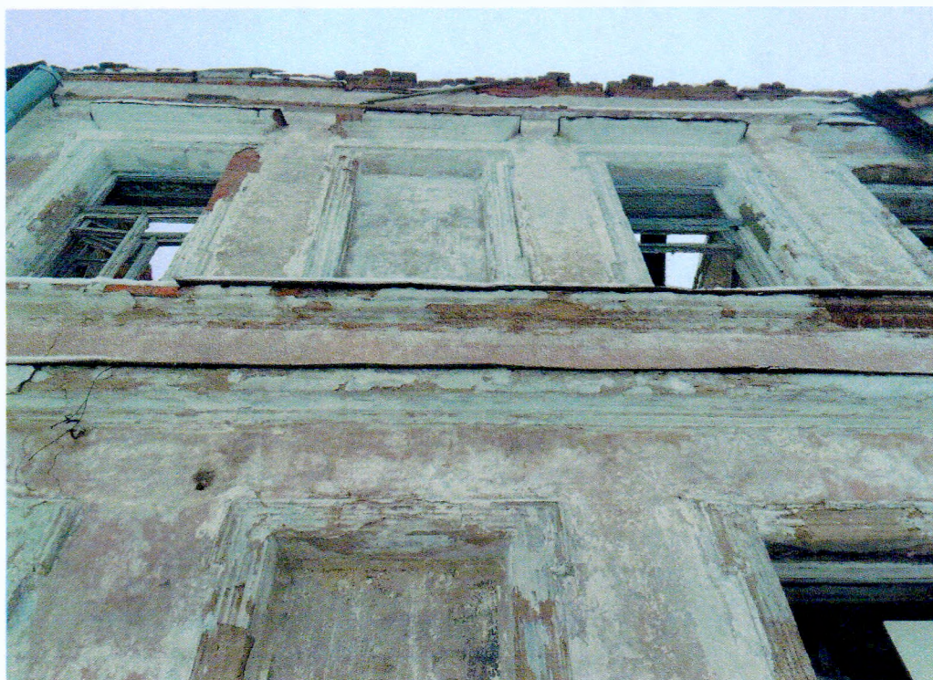
Фото 10. Фрагмент северо-западного фасада. Вид на оконные проемы 2 этажа. Декор в виде штукатурных профилированных сандриков. Разрушение кирпичной кладки в верхней части стены.
