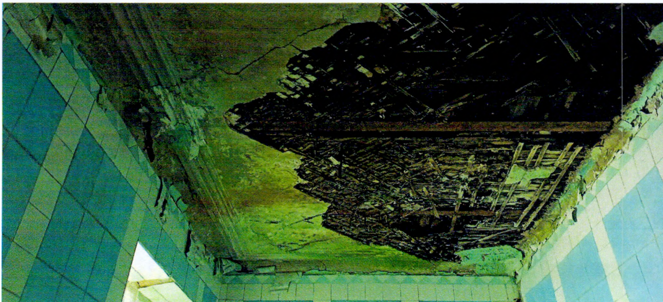
Фото 29. Вид на перекрытие 1 этажа. Перекрытия выполнены по металлическим балкам двутаврового сечения с подбором из доски и оштукатуриванием по дранке. Наблюдаются утраты деревянного подбора, штукатурного слоя, прогиб перекрытия и коррозия поверхности металла балок.
