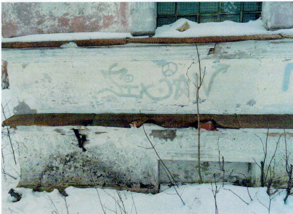
Фото 9. Фрагмент северо-западного фасада. Коррозия и смятие линейных отливов. Утрата поверхности штукатурного слоя цоколя «под шубу». Трещина в штукатурном слое под оконным проемом первого этажа. Вандальные надписи.
