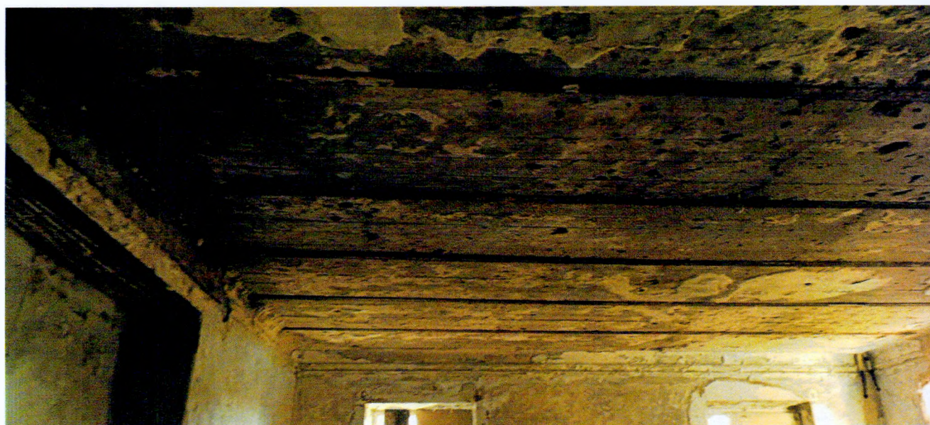
Фото 26. Вид на перекрытие 1 этажа. Перекрытия выполнены по металлическим балкам двутаврового сечения с бетонным заполнением. Наблюдается прогиб перекрытия и коррозия поверхности металла балок.
