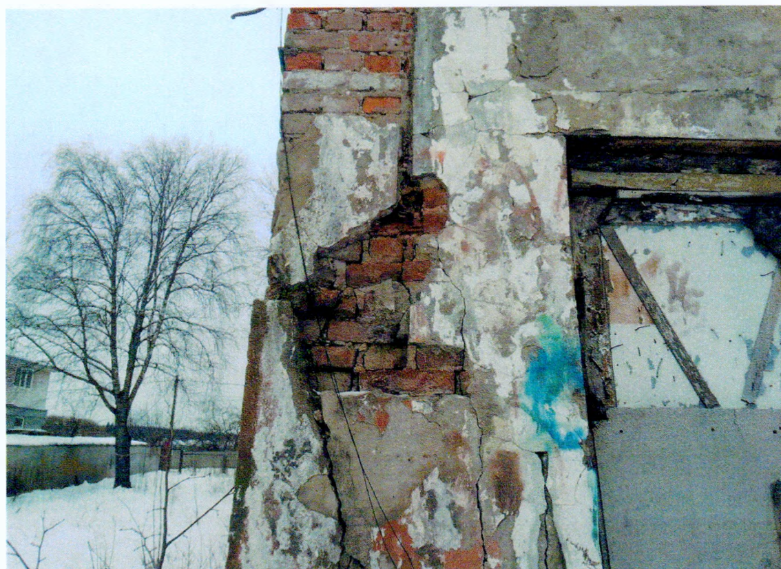
Фото 18. Фрагмент северного фасада. Утрата штукатурного слоя. Деструкция кирпичной кладки.
