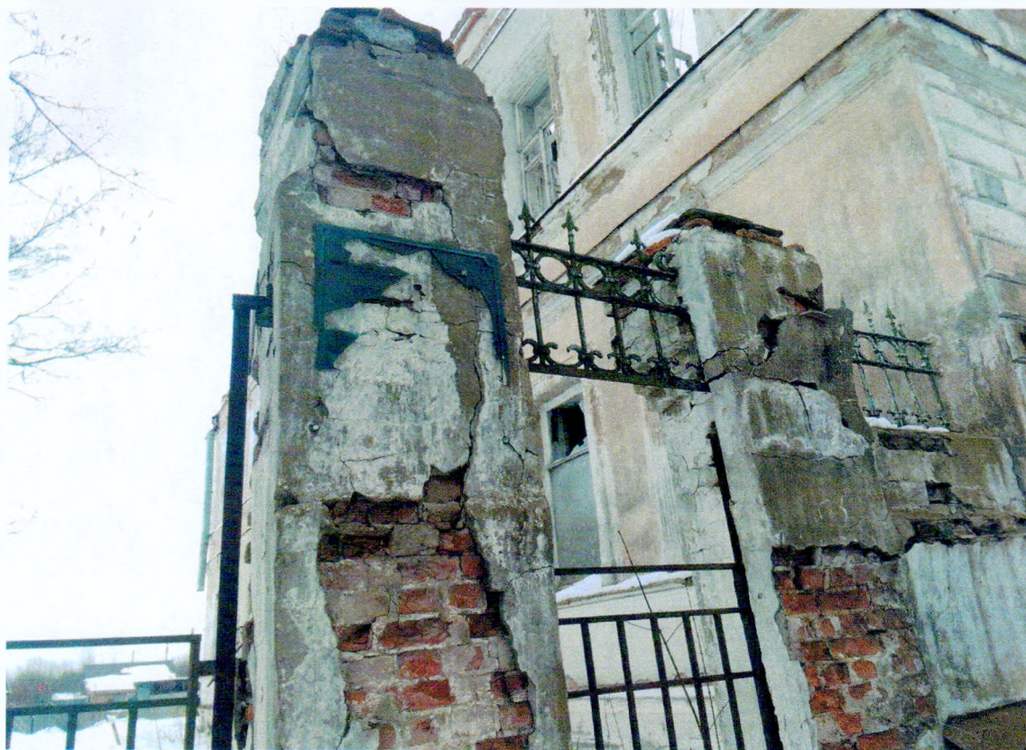
Фото 36. Ворота в северной части лицевого фасада. Разрушение штукатурного слоя, деструкция кирпичной кладки.
