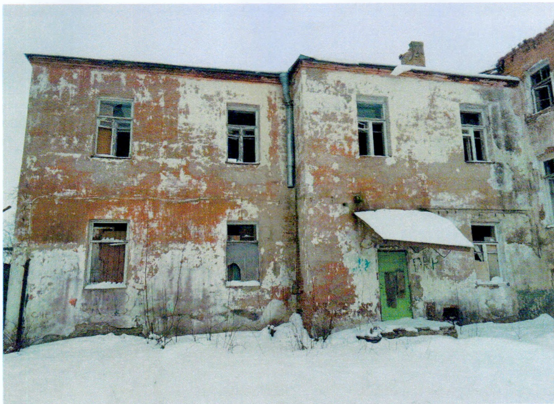
Фото 15. Вид на северо-западный фасад. Утраты штукатурного слоя.
