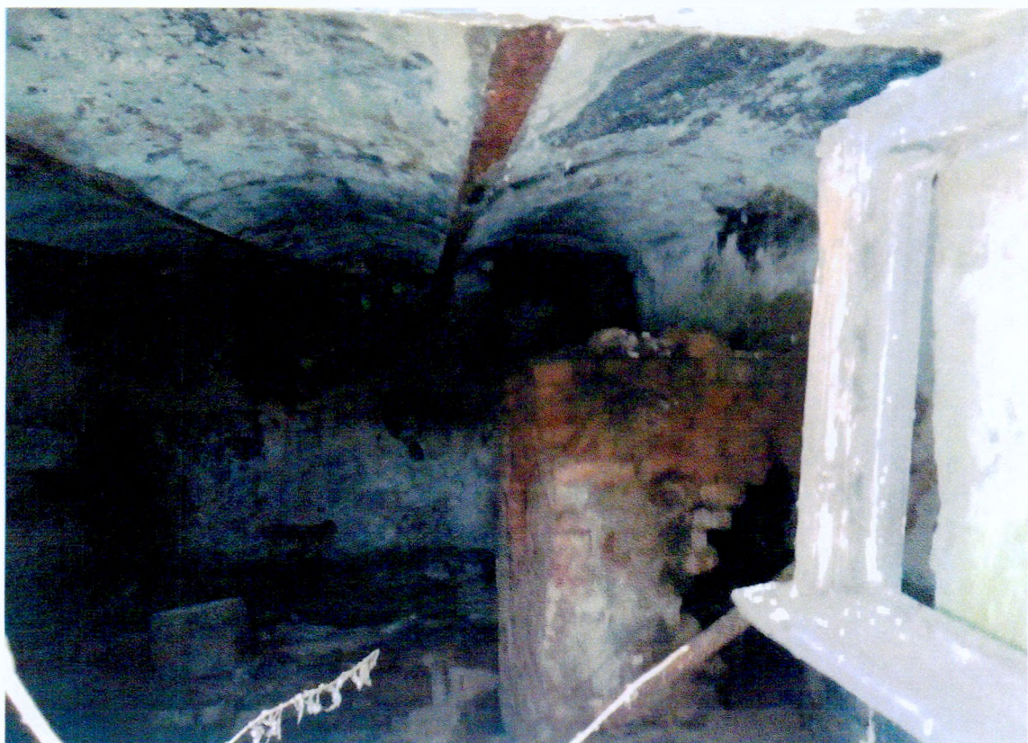
Фото 24. Сводчатое перекрытие над подвалом. Коррозия металлических балок.
