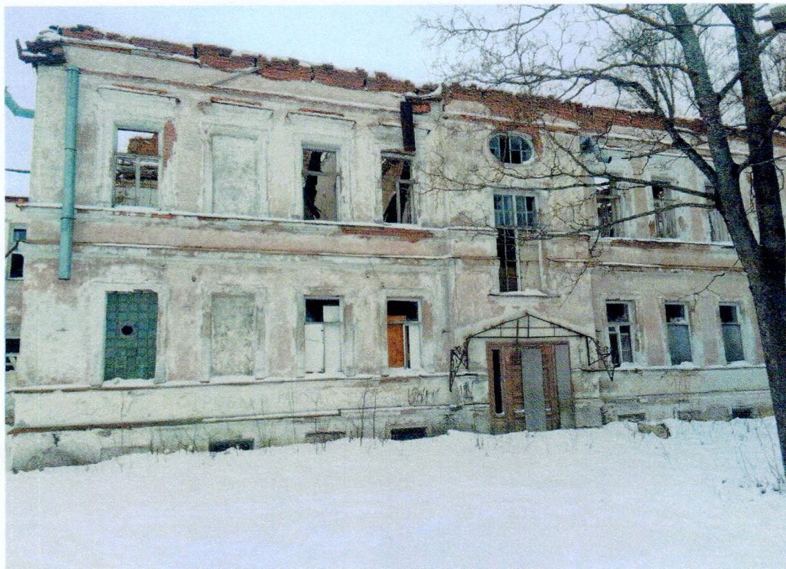
Фото 8. Северо-западный фасад. Заполнение оконных проемов и кровля утрачены. Частично сохранились кованые металлические кронштейны навеса.
