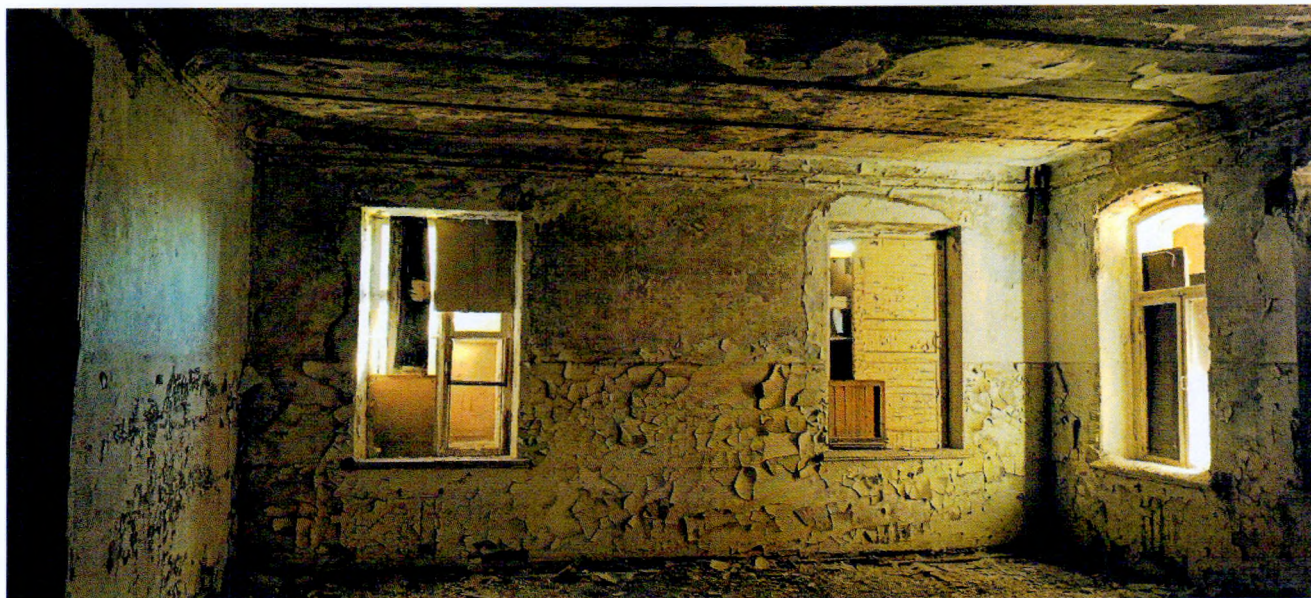
Фото 25. Помещение 1 этажа. Перекрытия выполнены по металлическим балкам двутаврового сечения с бетонным заполнением. Наблюдается прогиб перекрытия и коррозия поверхности металла балок. Историческая отделка помещения утрачена.
