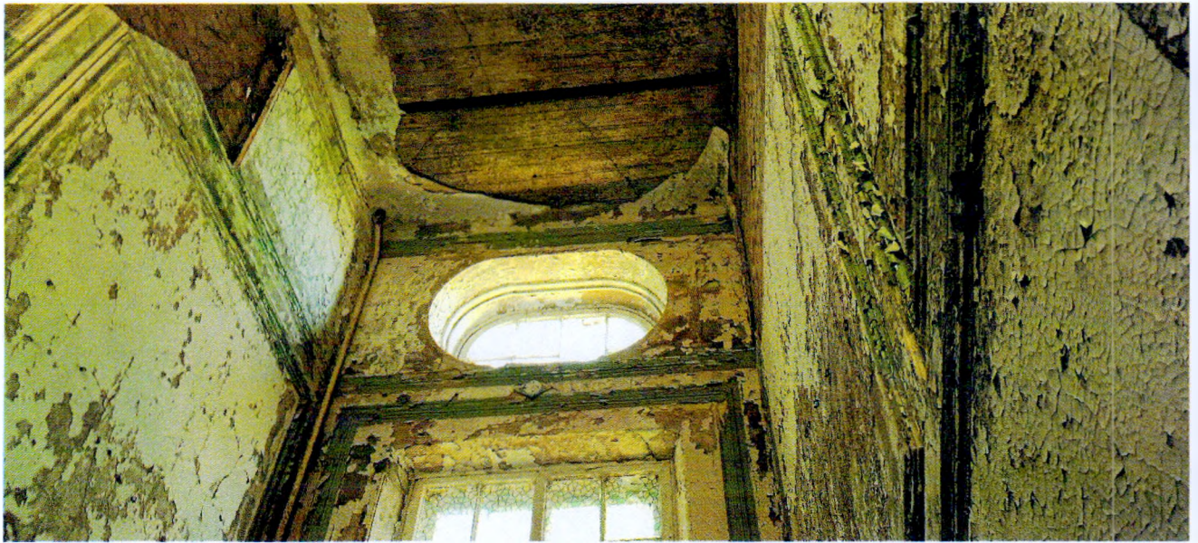
Фото 31. Помещение главной лестницы. Наблюдаются значительные участки утраты штукатурного слоя.
