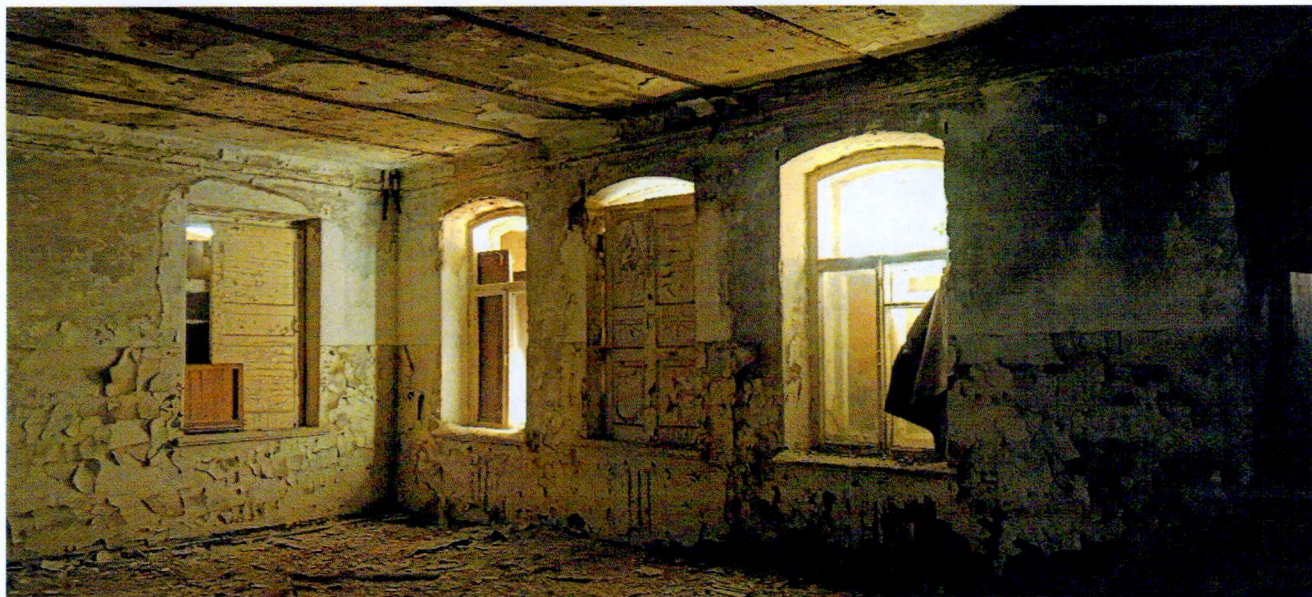
Фото 27. Помещение 1 этажа. Перекрытия выполнены по металлическим балкам двутаврового сечения с бетонным заполнением. Наблюдается прогиб перекрытия и коррозия поверхности металла балок. Историческая отделка помещения утрачена.
