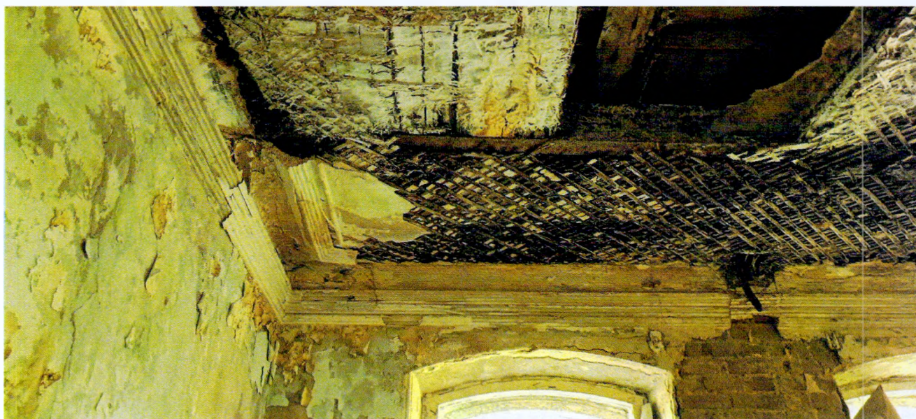
Фото 30. Вид на перекрытие 1 этажа. Перекрытия выполнены по металлическим балкам двутаврового сечения с подбором из доски и оштукатуриванием по дранке. Наблюдаются утраты деревянного подбора, штукатурного слоя, прогиб перекрытия и коррозия поверхности металла балок.
