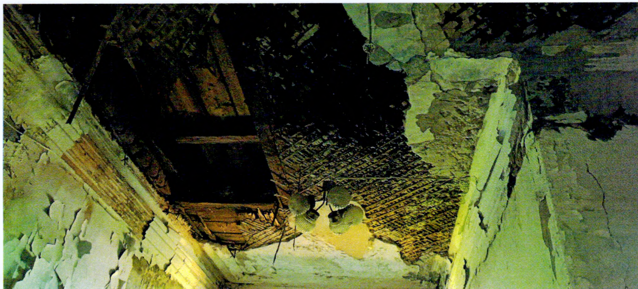
Фото 28. Вид на перекрытие 1 этажа. Перекрытия выполнены по металлическим балкам двутаврового сечения с подбором из доски и оштукатуриванием по дранке. Наблюдаются утраты деревянного подбора, штукатурного слоя, прогиб перекрытия и коррозия поверхности металла балок.
