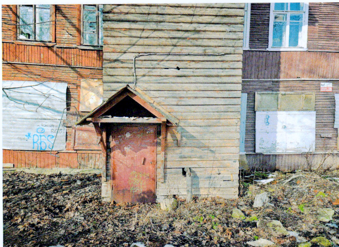
Фото 8. Фрагмент юго-восточного фасада. Деформация конструкций, искривление горизонтальных линий фасада.
