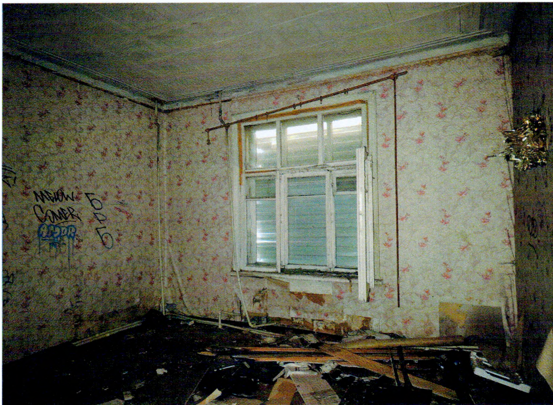
Фото 13. Помещение квартиры. Утрата радиаторов отопления.
