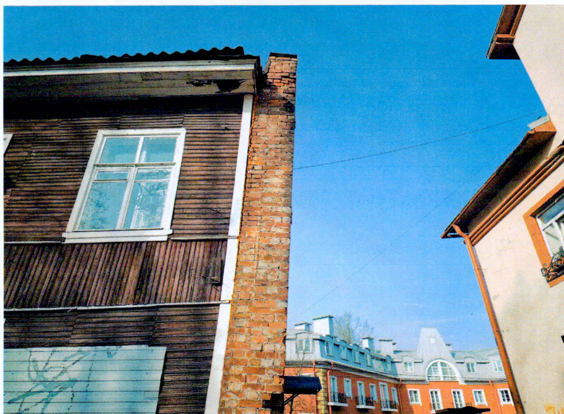
Фото 9. Фрагмент юго-восточного фасада. Отклонение брандмауэрной стены от вертикали.
