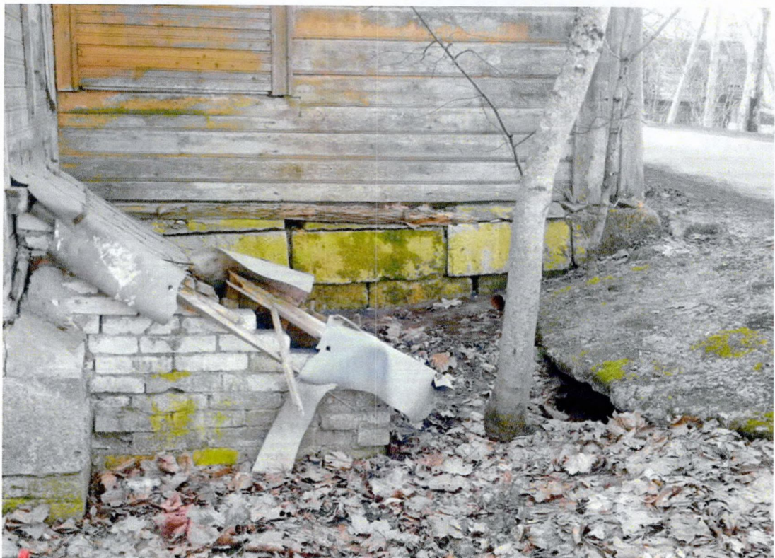
Фото 8. Фрагмент восточного фасада. Провал территории. Деформация и биоповреждение цоколя.
