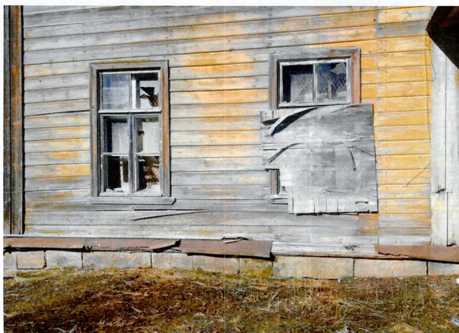
Фото 2. Фрагмент южного фасада. Искривление горизонтальной линии цоколя. Повреждения и утраты остекления оконных проемов.
