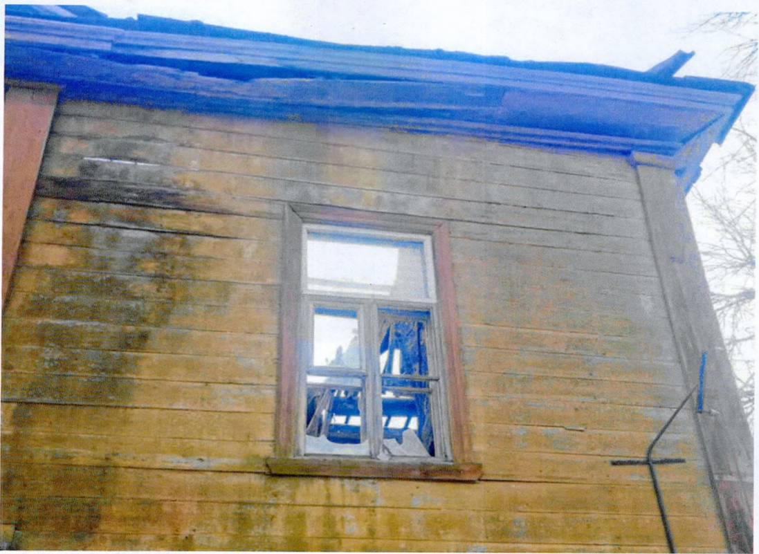
Фото 13. Фрагмент северного фасада. Просматривается разрушение конструкций чердачного перекрытия и крыши.
