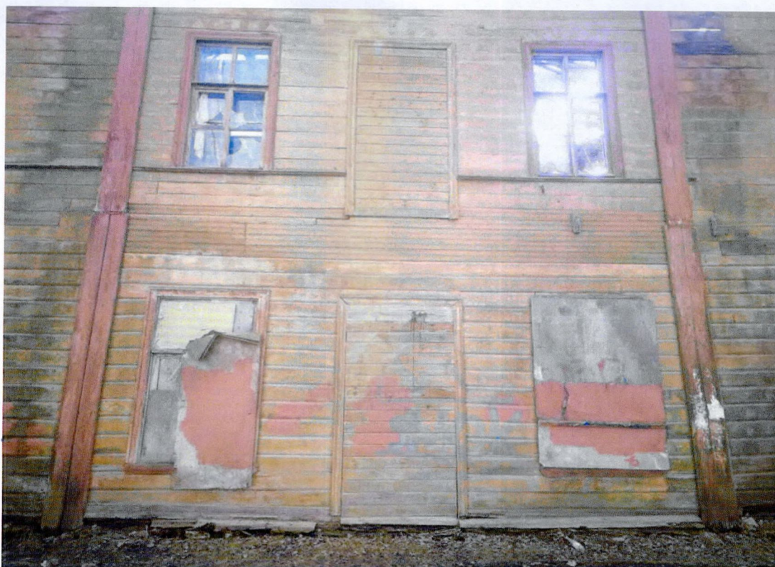
Фото 11. Фрагмент северного фасада. Искривление горизонтальной линии цоколя. Деформация конструкций. Часть проемов защиты. Остекление повреждено.
