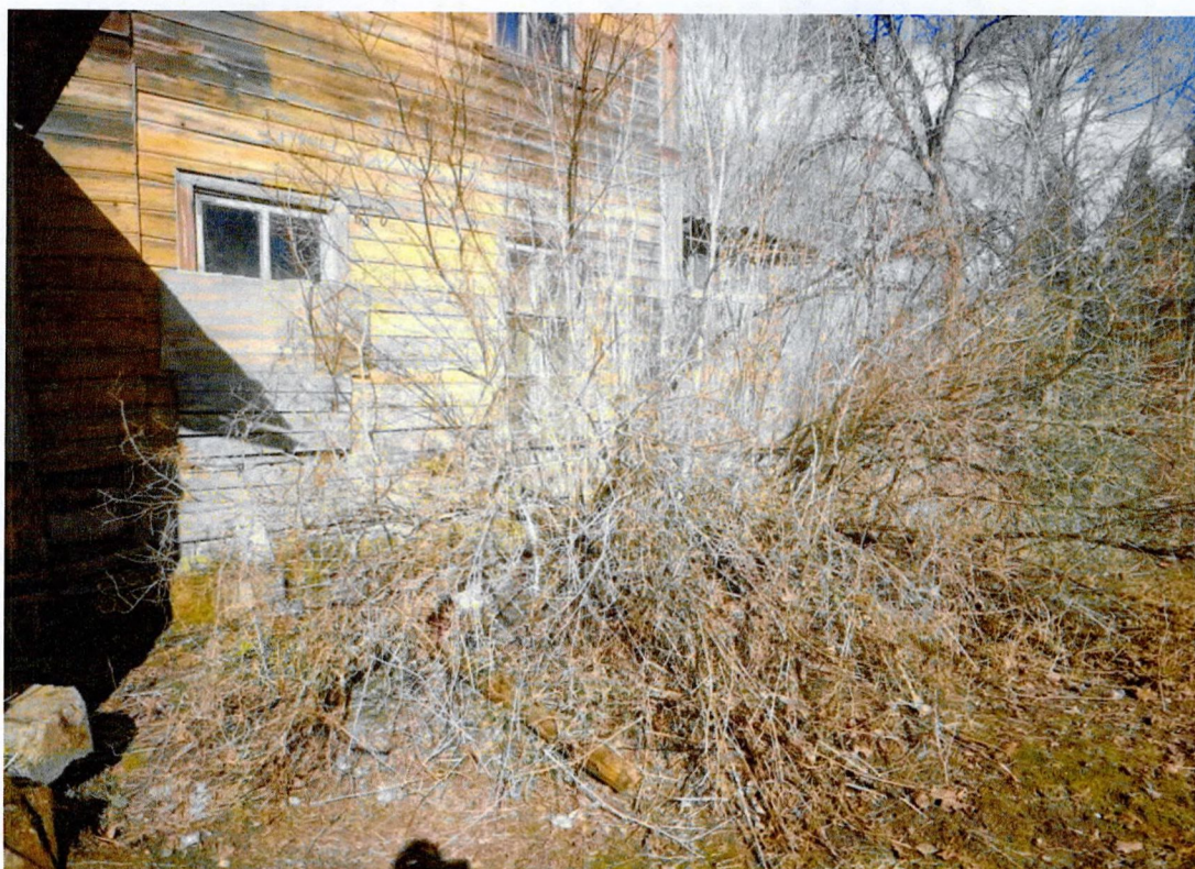
Фото 4. Фрагмент южного фасада. Заращение прилегающей к цоколю здания территории кустарниками.
