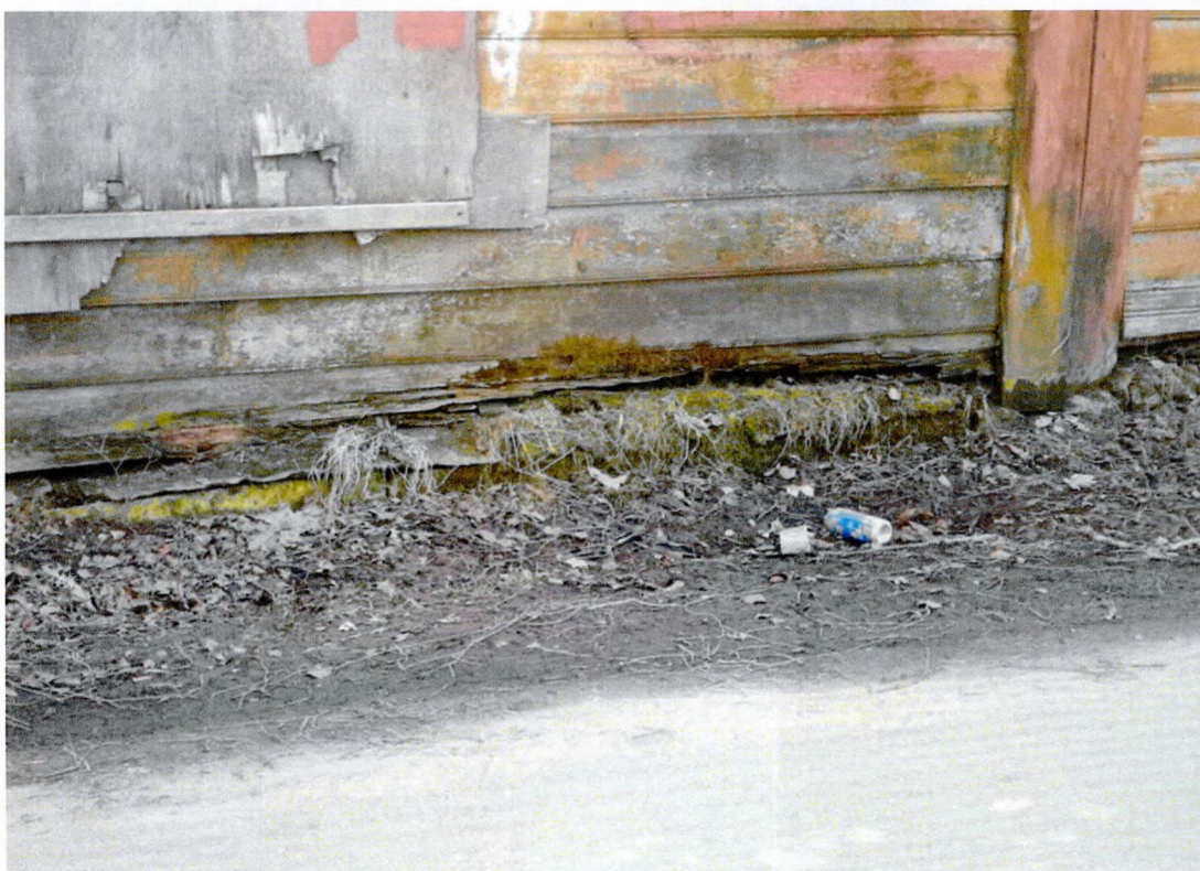
Фото 10. Фрагмент северного фасада. Биоповреждение цоколя и обшивки.
