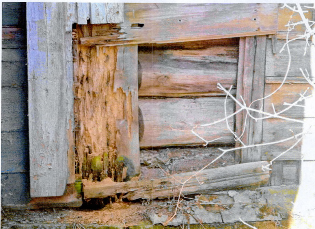
Фото 5. Фрагмент южного фасада. Утрата части обшивки. Плесневые повреждения венцов.
