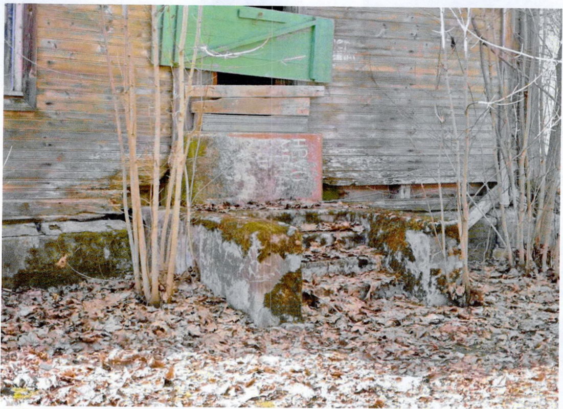
Фото 7. Фрагмент восточного фасада. Биоповреждения ступеней. Разрушения и утраты части обшивки фасада пристройки.
