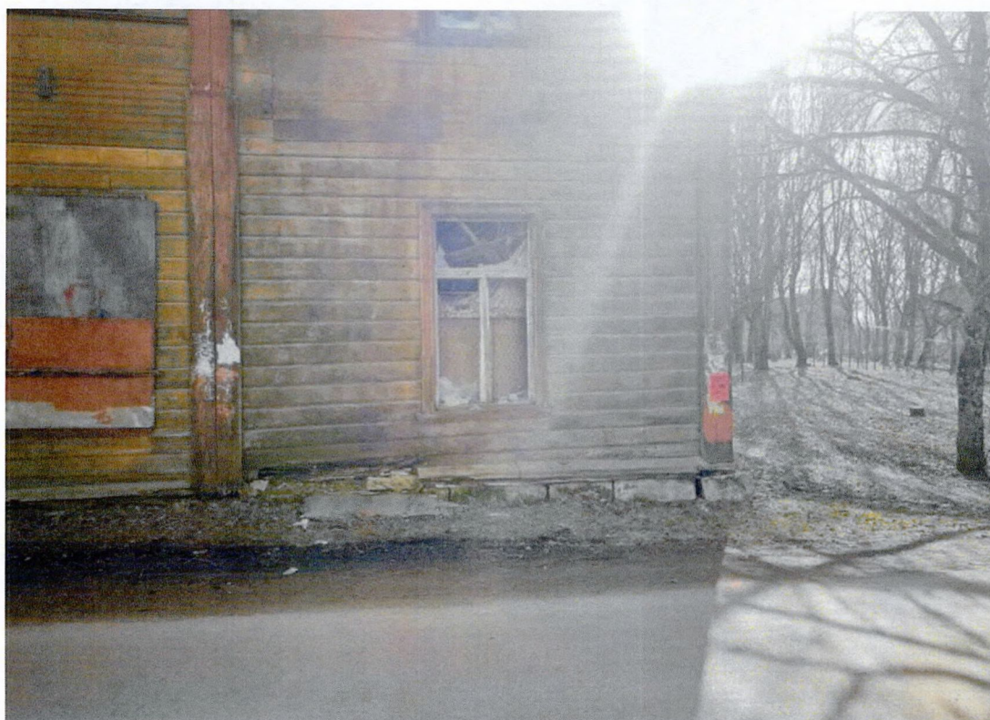
Фото 12. Фрагмент северного фасада. Потемнение и биоповреждение фасада. Разрушение и осадка угла здания.
