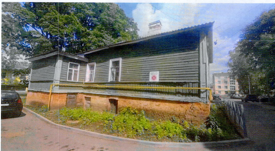
Фото 11. Южный фасад. Просадка юго-восточного угла.
