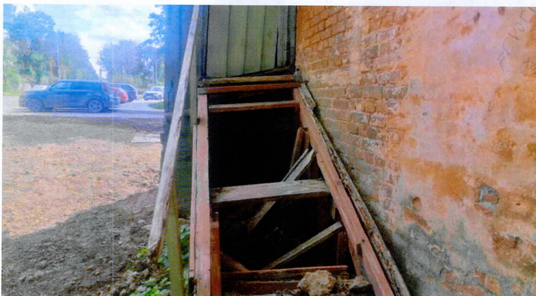
Фото 7. Фрагмент северного фасада. Разрушение деревянной лестницы крыльца.
