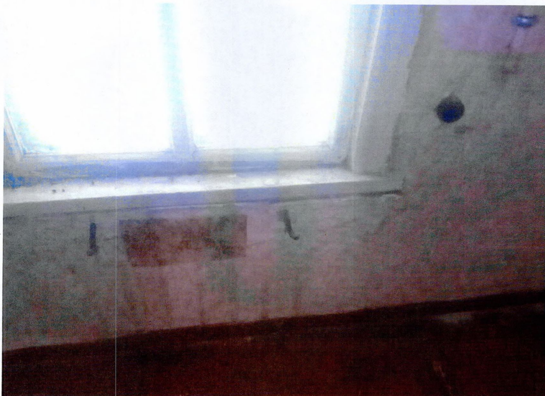
Фото 13. Утрата приборов отопления.
