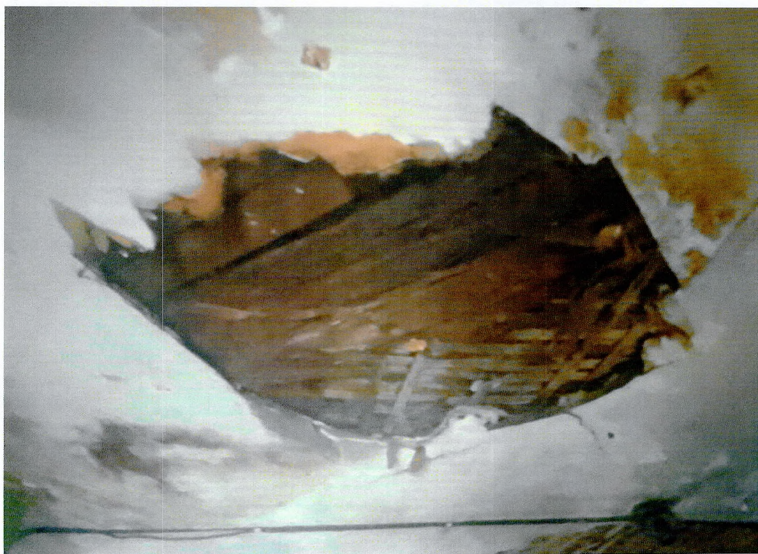
Фото 16. Обрушение отделочного слоя перекрытия. Гниль древесины.
