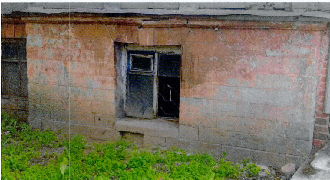
Фото 4. Фрагмент западного фасада. Деформация перемычки проема цокольного этажа, ослабление замкового камня.
