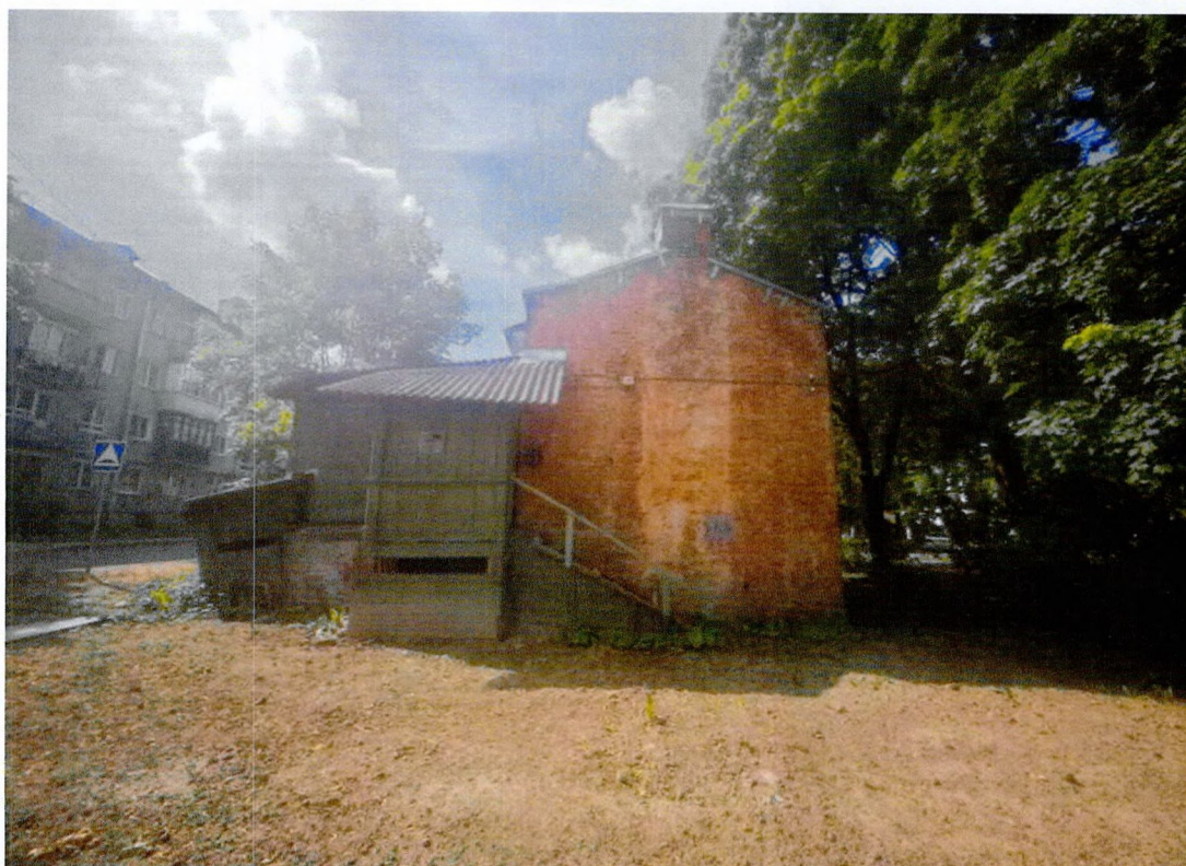
Фото 6. Северный фасад. Брандмауэрная стена. Перекос деревянных конструкций.
