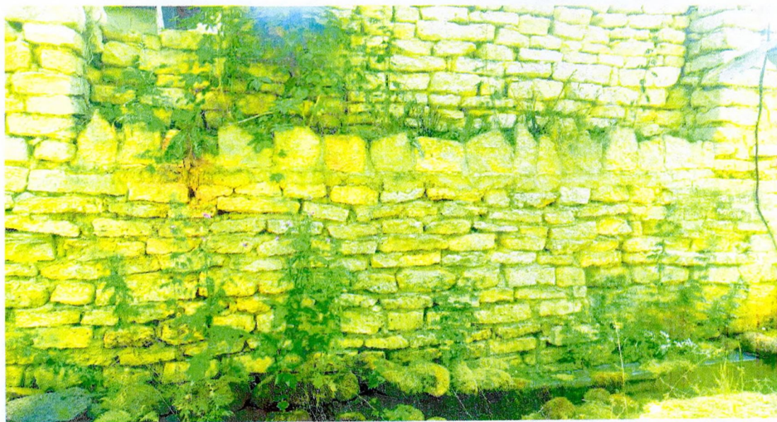
Фото 2. Вид на фрагмент северного фасада. Материал – обработанные каменные блоки. Шовное заполнение утрачено. Наблюдаются сколы на поверхности каменных блоков. Отмостка утрачена.
