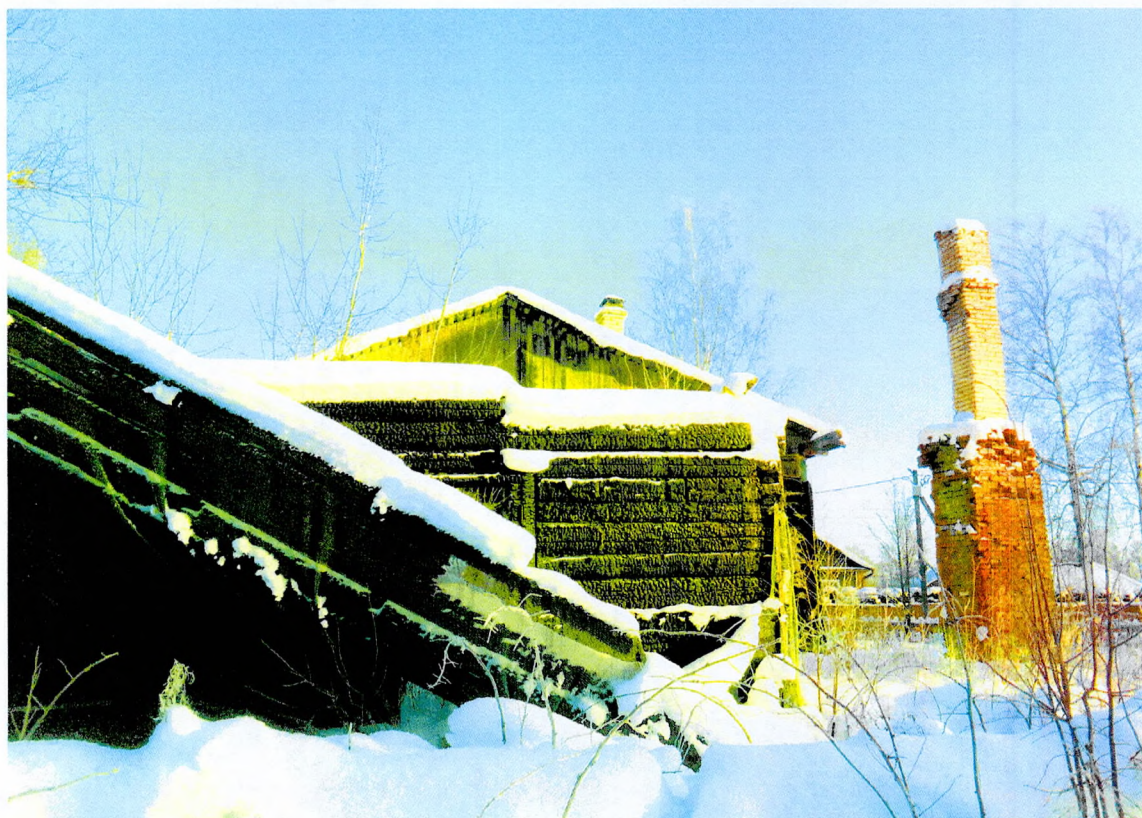
Фото 9. Фрагмент юго-восточного фасада. Следы обугливания конструкций.
