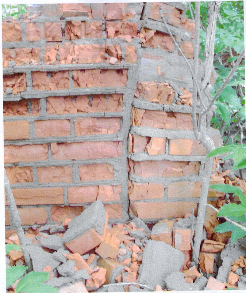
Фото 6. Обилие порослевых зеленых насаждений, корневая система которых оказывает деформационное воздействие на конструкции
