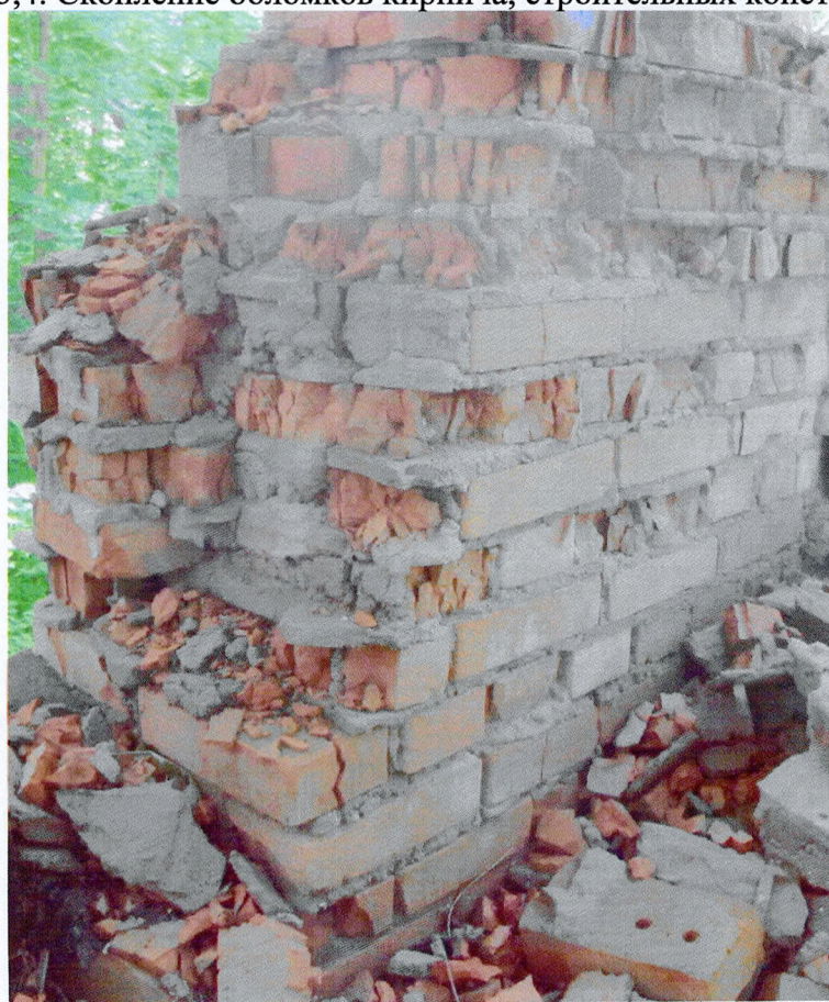
Фото 5. Разрушение и выветривание растворных швов, выпадение кирпича
